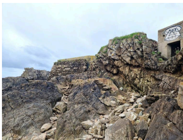
Vue de situation (du côté de l'entrée du bunker vers l'est). De ce côté de l'îlot, l'érosion marine est forte. Derrière la maçonnerie de moellon se cache le bunker - abri Phot. Guillaume Lécueillier IVR53_20242911213NUCA
