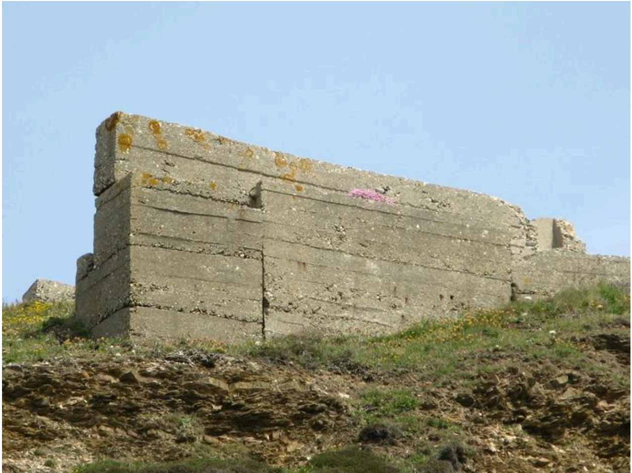
Poste de chargement de galets
