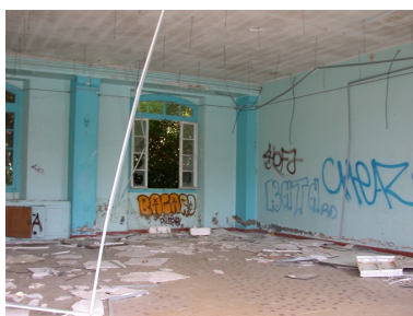
Vue intérieure de l'un des ateliers, désaffecté et pillé Phot. Guy Prigent IVR53_20092212453NUCA
