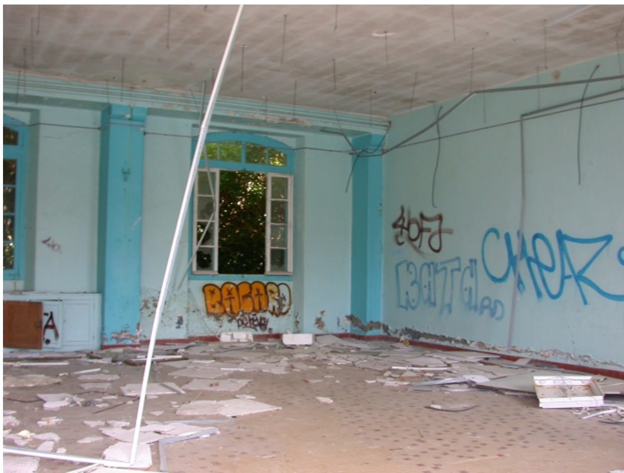
Vue intérieure de l'un des ateliers, désaffecté et pillé
