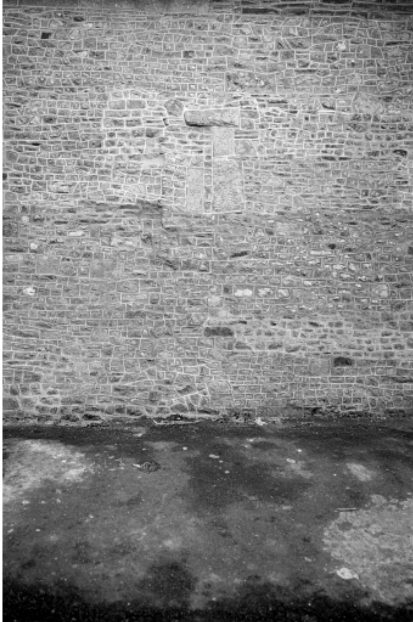
Façade Nord, nef, détail des reprises.
