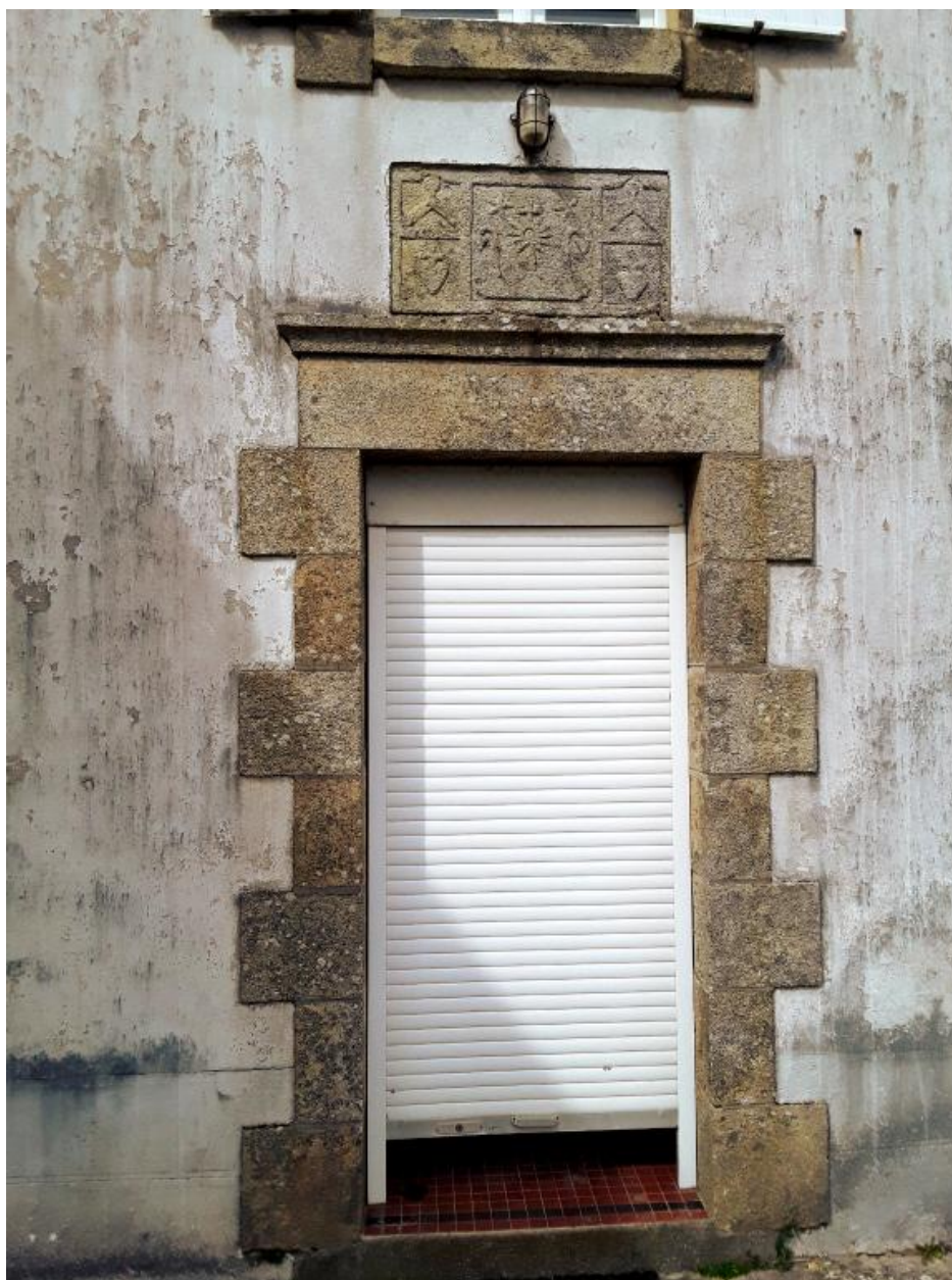
Maison 5, détail du linteau de la porte d'entrée. (2018)
