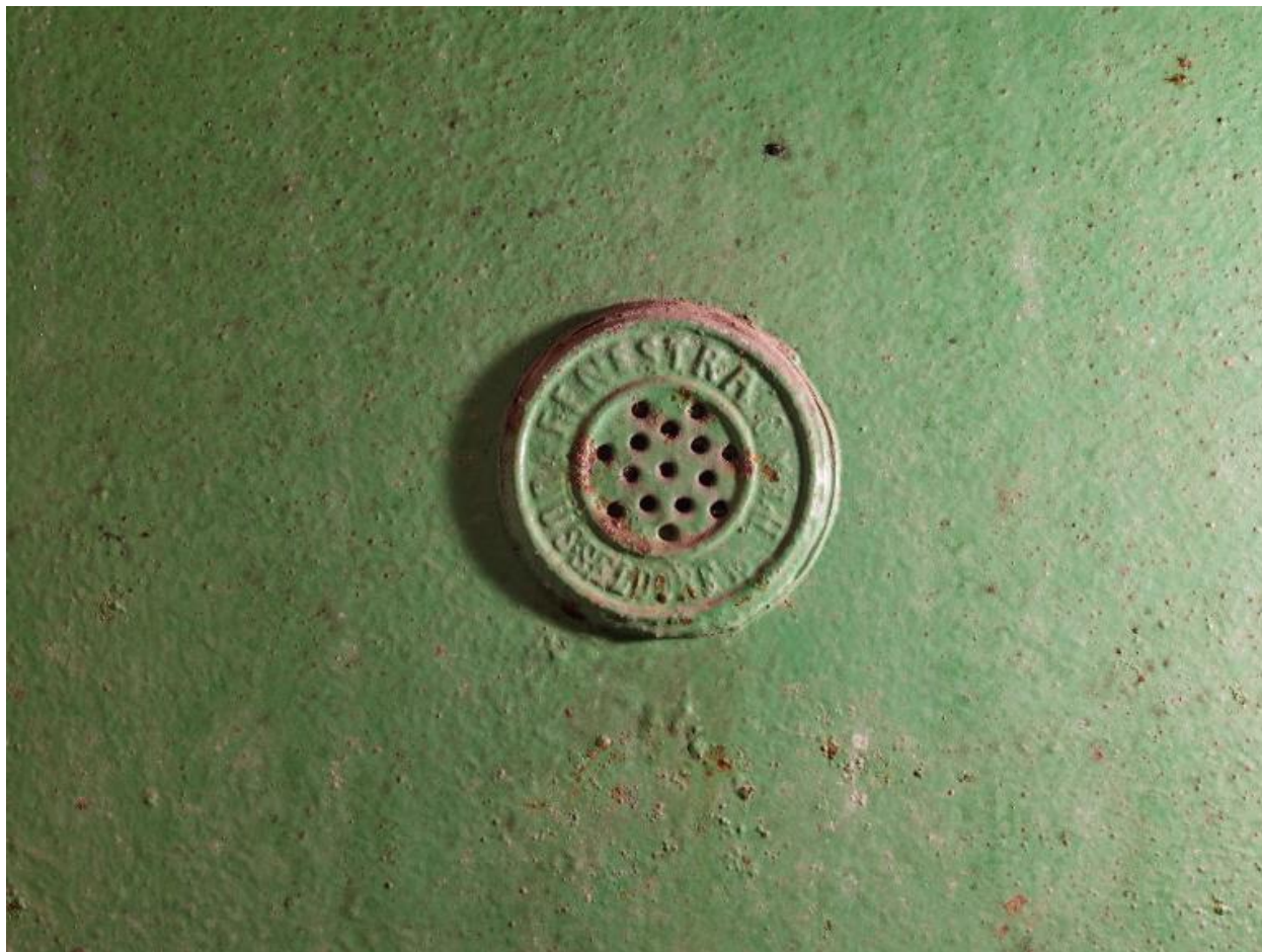
Vue de détail de la porte étanche du vestibule : #illeton. On peut lire : FENESTRA DUSSELDORF
