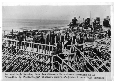
Image de propagande nazie : "Au bord de la Manche, dans les dunes... De nombreux ouvrages de la Muraille de l'Atlantique viennent encore s'ajouter à ceux déjà terminés" Repr. Andrea Santangelo IVR53_20042903578NUCA
