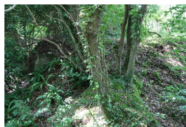
Vue de la dalle de couverture envahie par la végétation Phot. Guillaume Lécueillier IVR53_20242910263NUCA
