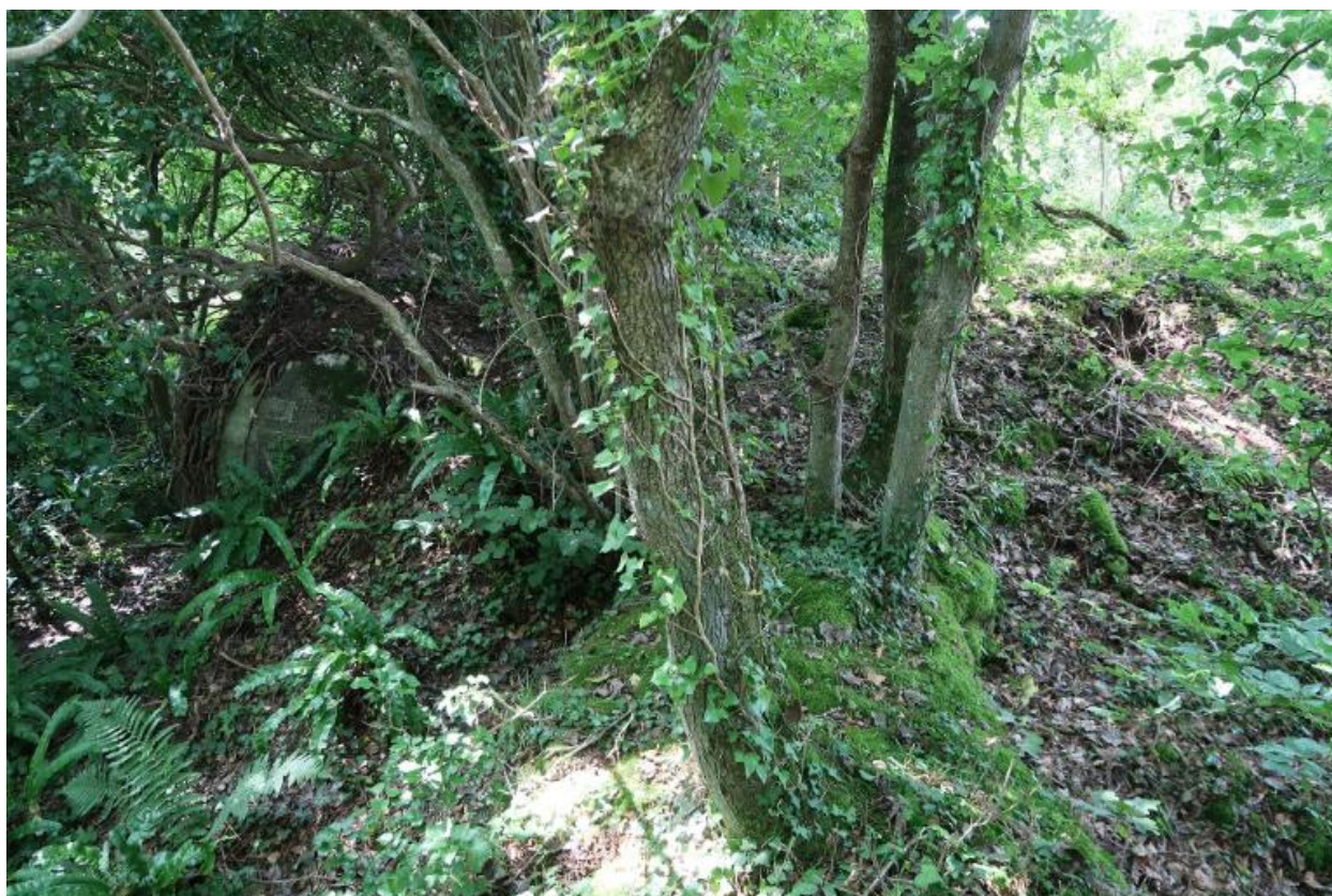
Vue de la dalle de couverture envahie par la végétation
