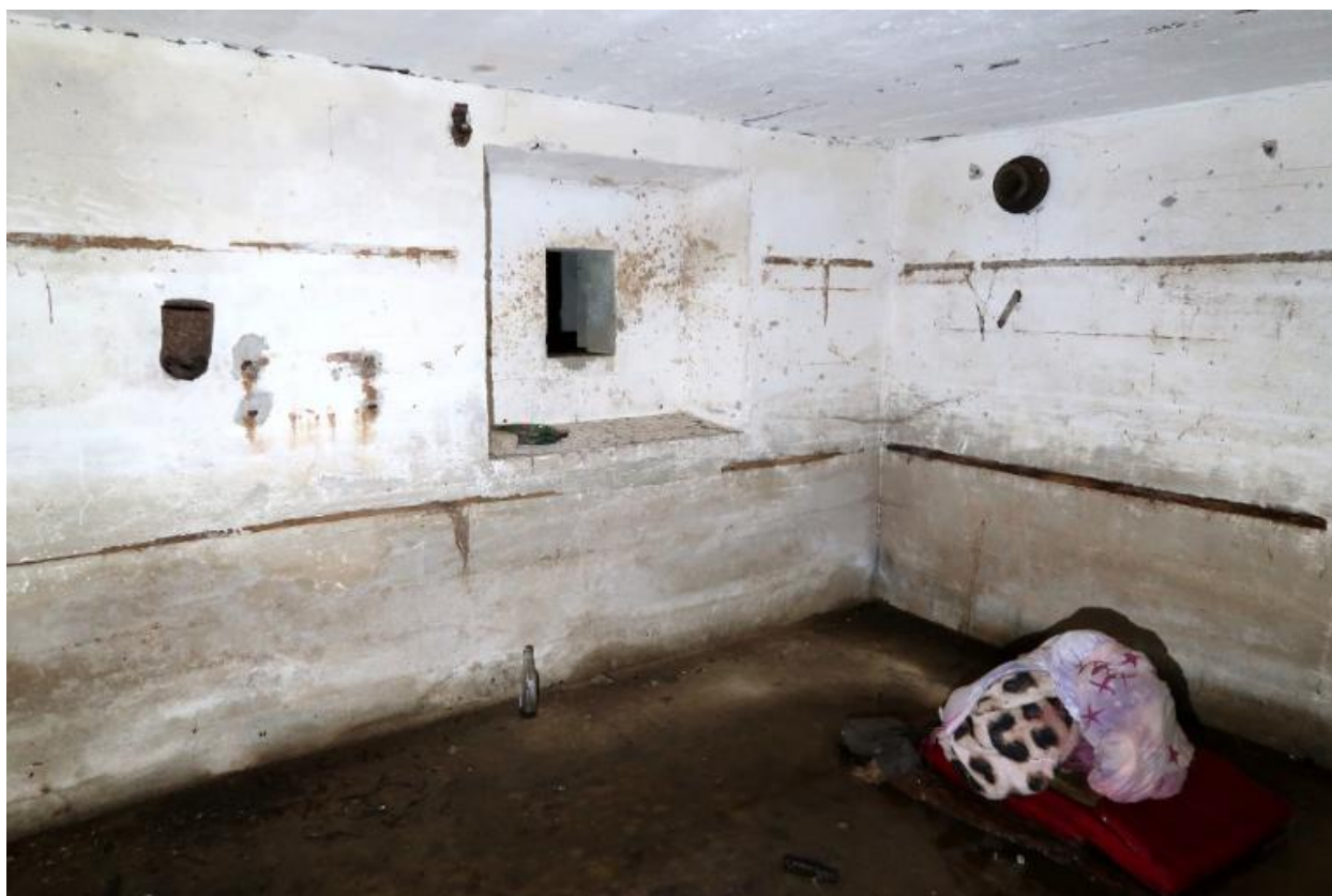
Vue intérieure : angle sud-ouest de la de la salle de garde ouest avec [de gauche à droite] l'emplacement du ventilateur, du créneau blindé [non posé] et de la conduite du poêle. Baignant dans l'eau, divers déchets
