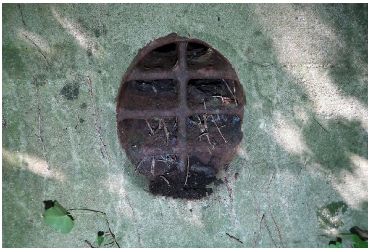
Vue de la prise d'air externe située à droite de l'entrée est
