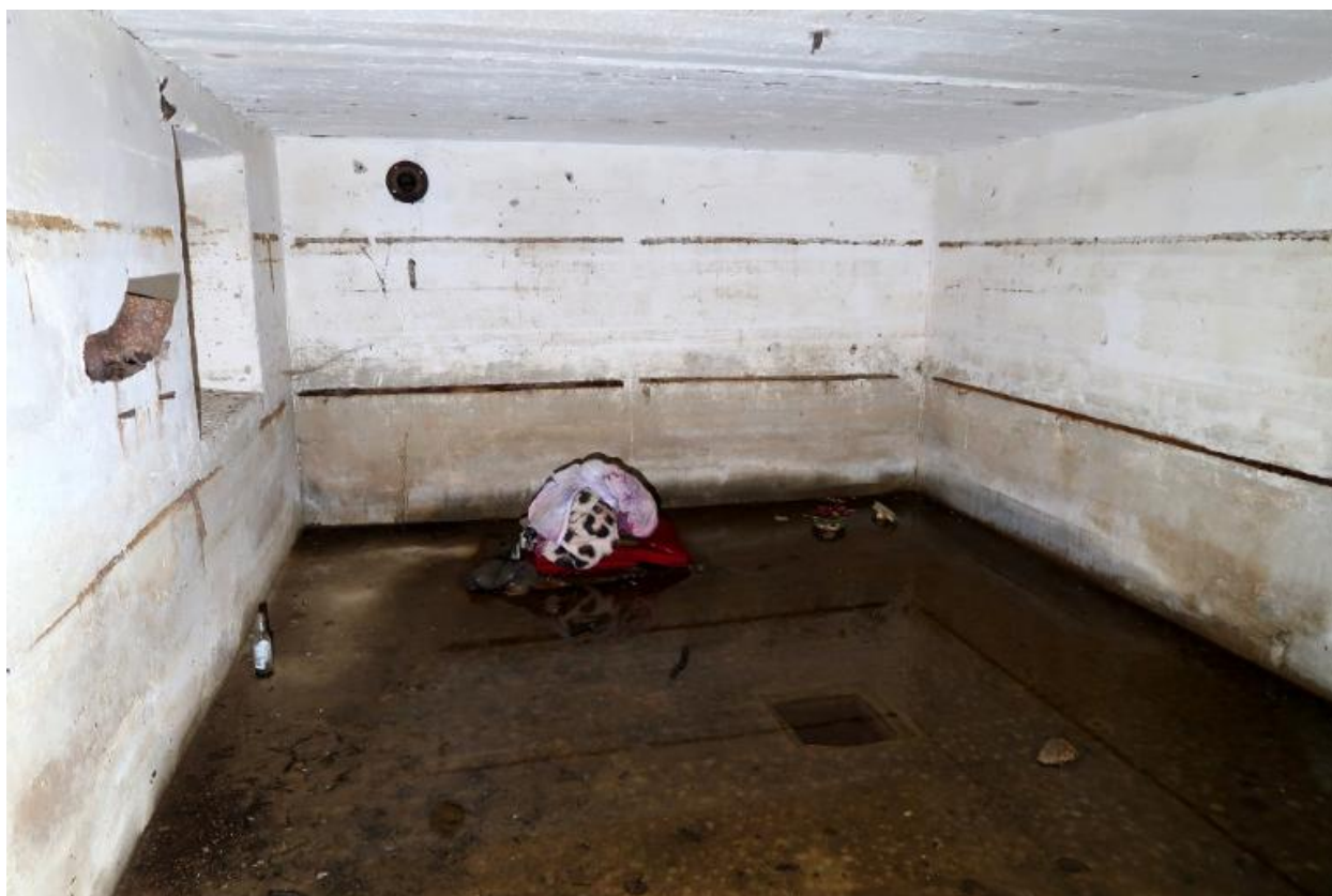
Vue intérieure : salle de garde ouest avec [de gauche à droite] l'emplacement du ventilateur, du créneau blindé [non posé] et de la conduite du poêle. Les murs sont blanchis à la chaux. Baignant dans l'eau, divers déchets
