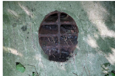
Vue de la prise d'air externe située à droite de l'entrée est Phot. Guillaume Lécueillier IVR53_20242910260NUCA
