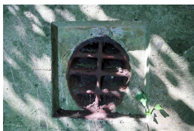
Vue de la prise d'air externe située à droite de l'entrée ouest Phot. Guillaume Lécueillier IVR53_20242910261NUCA
