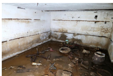
Vue intérieure : salle de garde est. Divers déchets baignent dans l'eau et la boue... Phot. Guillaume Lécueillier IVR53_20242910303NUCA
