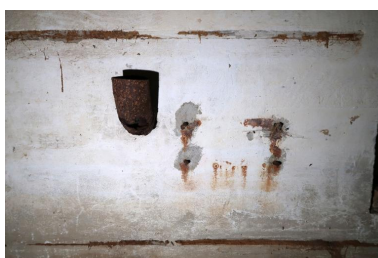
Vue intérieure : détail de la fixation du ventilateur de la salle de garde ouest et tube relié à la prise d'air extérieur Phot. Guillaume Lécueillier IVR53_20242910298NUCA
