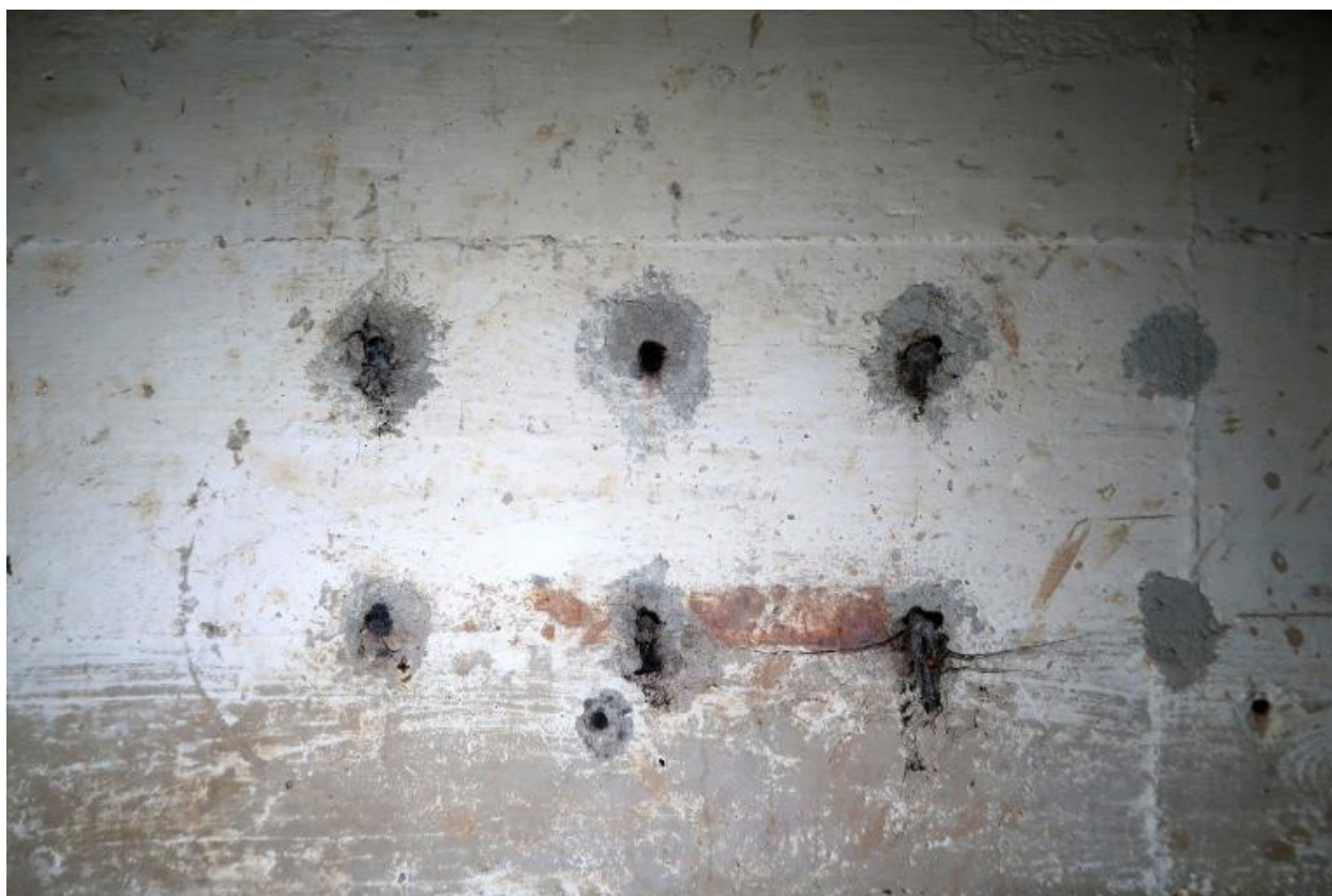
Vue intérieure : détail de la fixation du ventilateur de la salle de garde est
