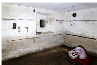
Vue intérieure : angle sud-ouest de la de la salle de garde ouest avec [de gauche à droite] l'emplacement du ventilateur, du créneau blindé [non posé] et de la conduite du poêle. Baignant dans l'eau, divers déchets Phot. Guillaume Lécueillier IVR53_20242910297NUCA
