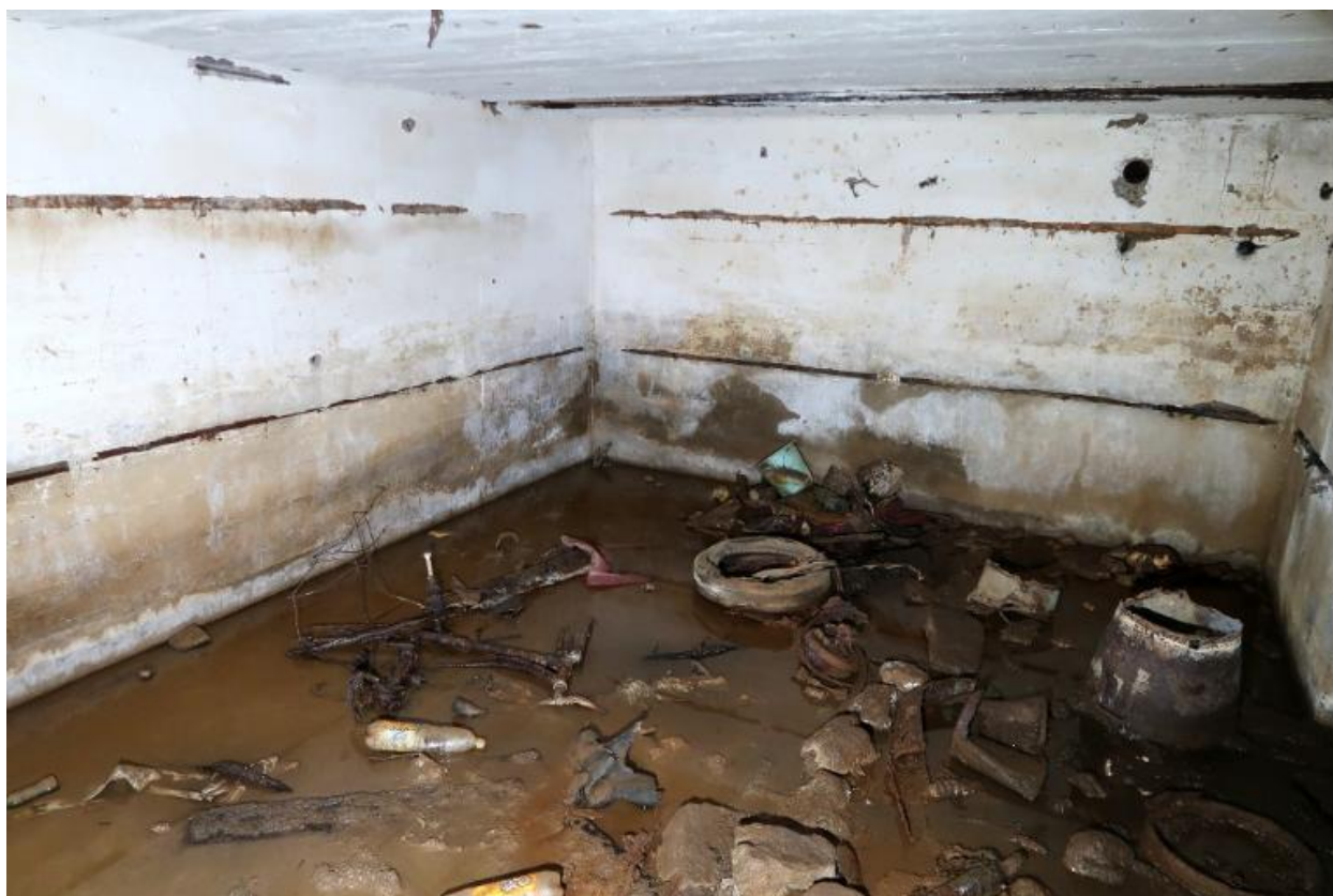
Vue intérieure : salle de garde est. Divers déchets baignent dans l'eau et la boue...
