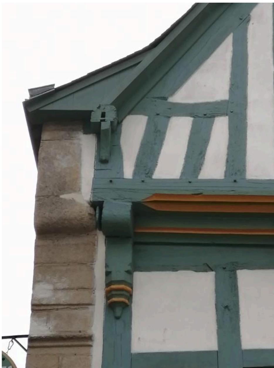
Détail de trous dans les poteaux et solives
