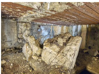
Vue du bunker - abri de type 502 situé à l'extrémité Est de la pointe : pièce de vie - chambrée Nord depuis le sas après explosion. Le mur en béton du sas, projeté et basculé, témoigne de sa violence Phot. Bernard Bègne IVR53_20232200405NUCA
