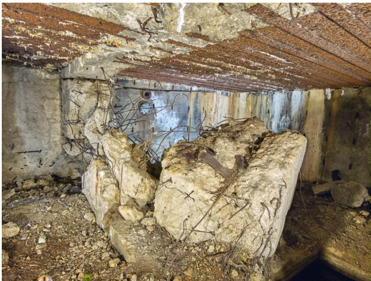
Vue du bunker - abri de type 502 situé à l'extrémité Est de la pointe : pièce de vie - chambre Nord depuis le sas après explosion. Le mur en béton du sas, projeté et basculé, témoigne de sa violence
