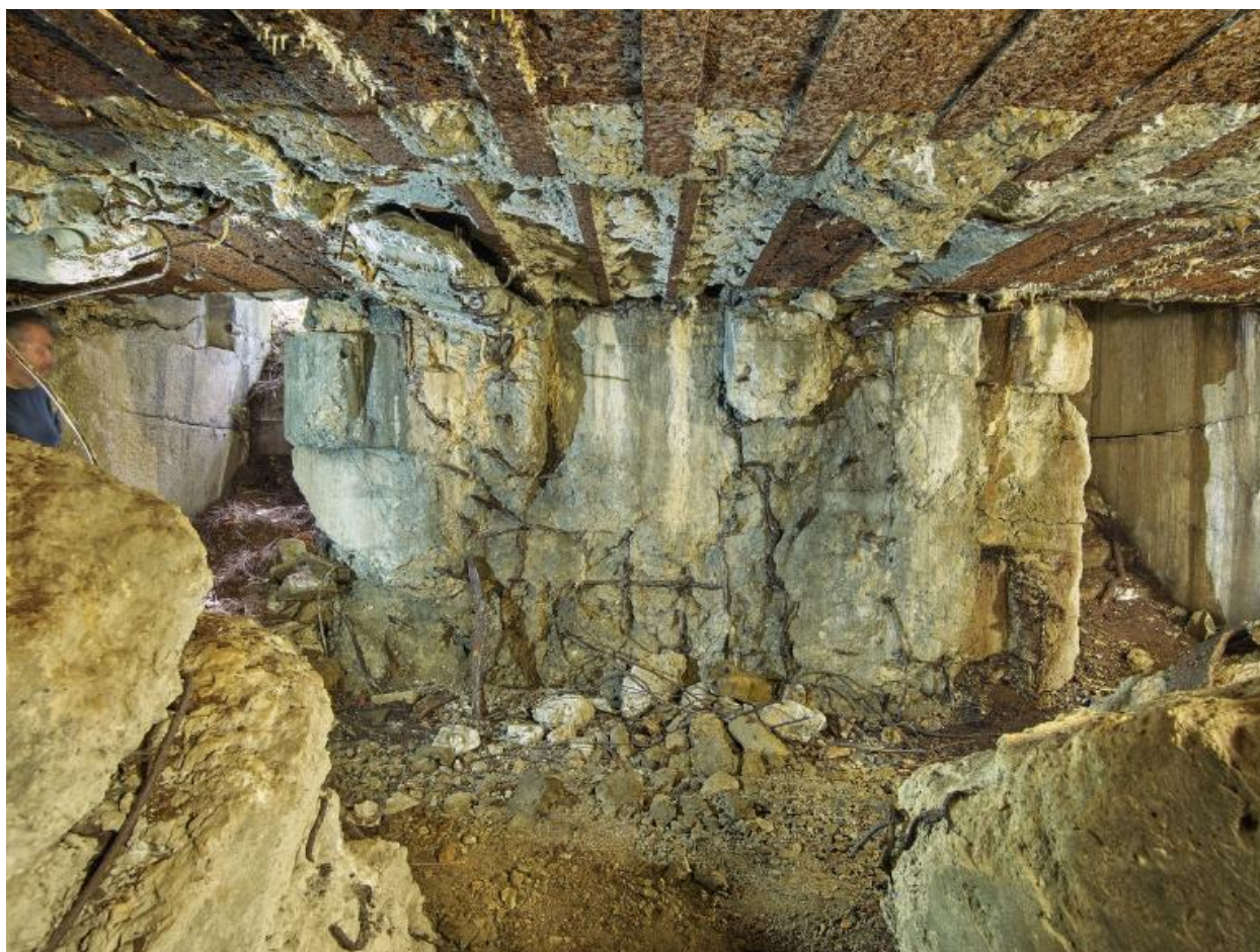
Vue du bunker - abri de type 502 situé à l'extrémité Est de la pointe : sas après explosion. De part et d'autre du sas se trouvent les entrées du bunker. Au centre, le ferrailage du bunker est particulièrement visible du fait de l'explosion
