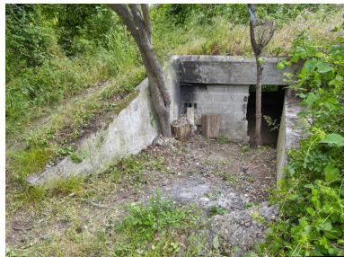
Vue du bunker - casemate de type VF pour un canon de 50 mm situé à l'extrémité Est de la pointe : entrée et rampe d'accès. Les murs latéraux protègent l'entrée qui était camouflée par un filet. L'entrée est partiellement murée par des parpaings et la chambre de tir est remblayée Phot. Bernard Bègne IVR53_20232200381NUCA
