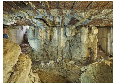
Vue du bunker - abri de type 502 situé à l'extrémité Est de la pointe : sas après explosion. De part et d'autre du sas se trouvent les entrées du bunker. Au centre, le ferrailage du bunker est particulièrement visible du fait de l'explosion Phot. Bernard Bègne IVR53_20232200415NUCA
