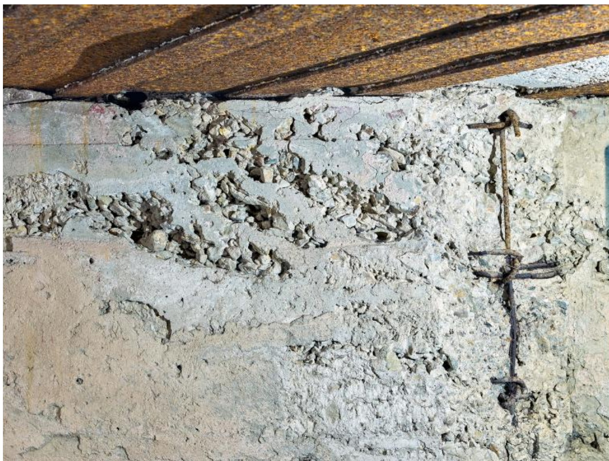
Vue de détail du béton armé constitué majoritairement de granulat sans ciment. A certains endroits, les fers à béton sont visibles du fait de la corrosion (Bunker - casemate de type 680 pour un canon de 7,5 cm ou 7,62 cm situé au Sud)
