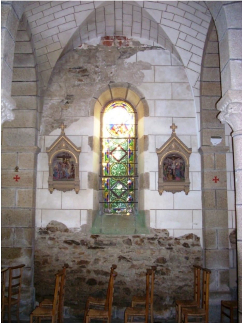
Saint-Ségal, église paroissiale Saint-Séverin : bas-côté nord, dégradation de l'enduit, détail
