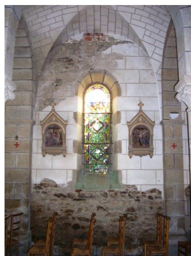
Saint-Ségéal, église paroissiale Saint-Séverin : bas-côté nord, dégradation de l'enduit, détail Phot. Gwénaél Fauchille IVR53_20082905610NUCA
