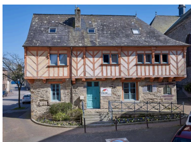
Façade ouest de l'édifice en pan de bois. Phot. Bernard Bègne IVR53_20215600277NUCA
