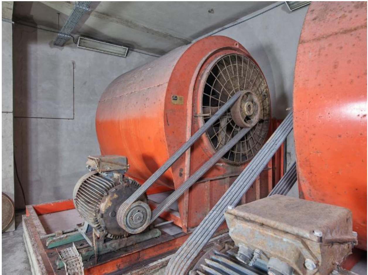
Vue de la salle des ventilateurs : les deux ventilateurs industriels de marque Fevi sont entraînés par des moteurs électriques via des courroies. Les carter de protection ont été déposés
