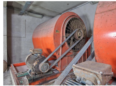
Vue de la salle des ventilateurs : les deux ventilateurs industriels de marque Fevi sont entraînés par des moteurs électriques via des courroies. Les carters de protection ont été déposés Phot. Bernard Bègne IVR53_20235600230NUCA
