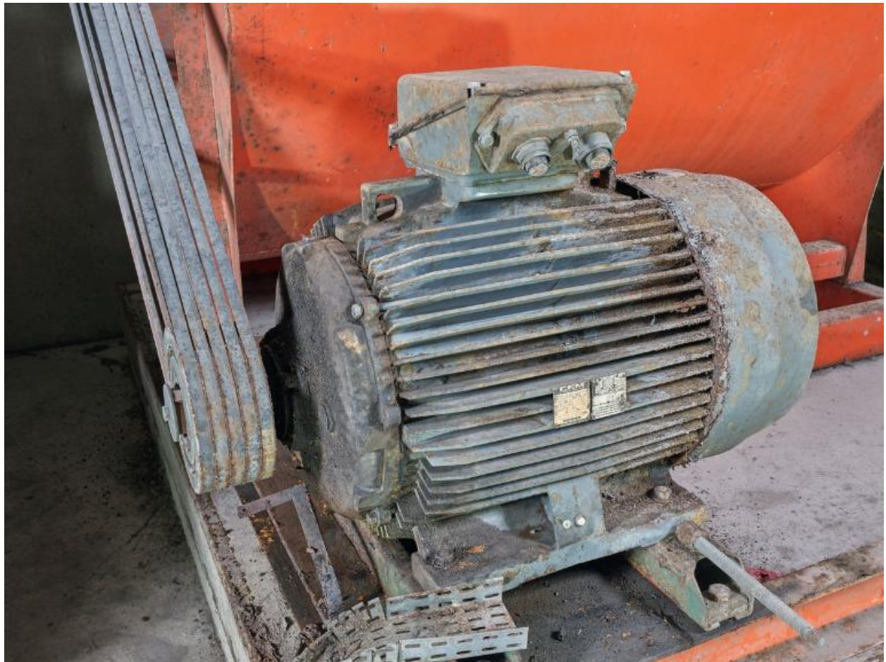
Vue de la salle des ventilateurs : moteur électrique de la Compagnie Electro-Mécanique entraînant via des courroies un ventilateur industriel de marque Fevi. Les fils d'alimentation ont été coupés
