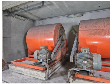
Vue de la salle des ventilateurs : les deux ventilateurs industriels de marque Fevi sont entraînés par des moteurs électriques via des courroies. Les carters de protection ont été déposés Phot. Bernard Bègne IVR53_20235600229NUCA
