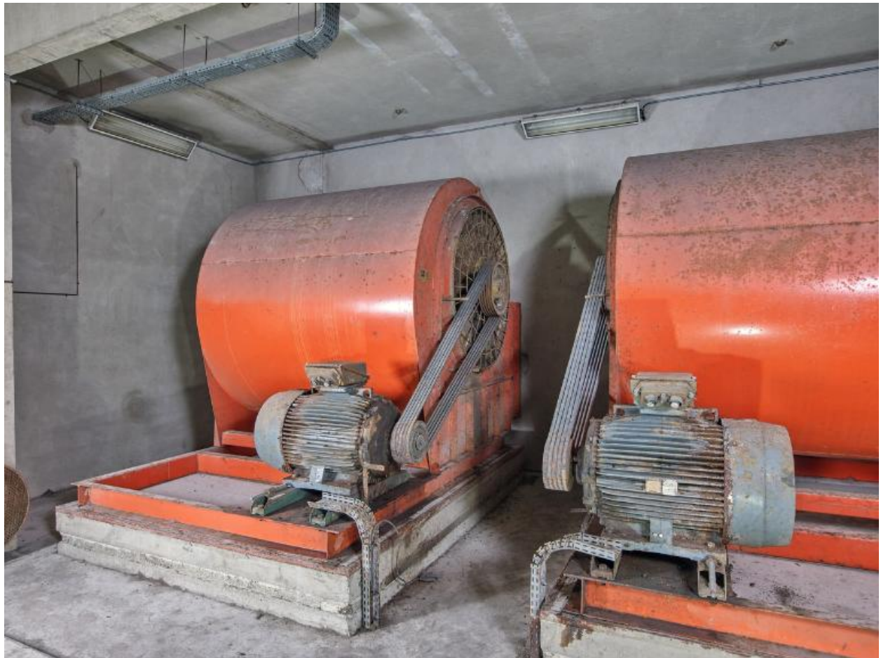
Vue de la salle des ventilateurs : les deux ventilateurs industriels de marque Fevi sont entraînés par des moteurs électriques via des courroies. Les carters de protection ont été déposés
