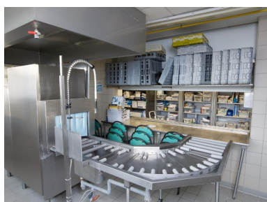
Ancien service de restauration : machine à laver la vaisselle (la restauration scolaire est, en 2021, mutualisée avec le lycée professionnel Emile James). Phot. Bernard Bègne IVR53_20195600704NUCA
