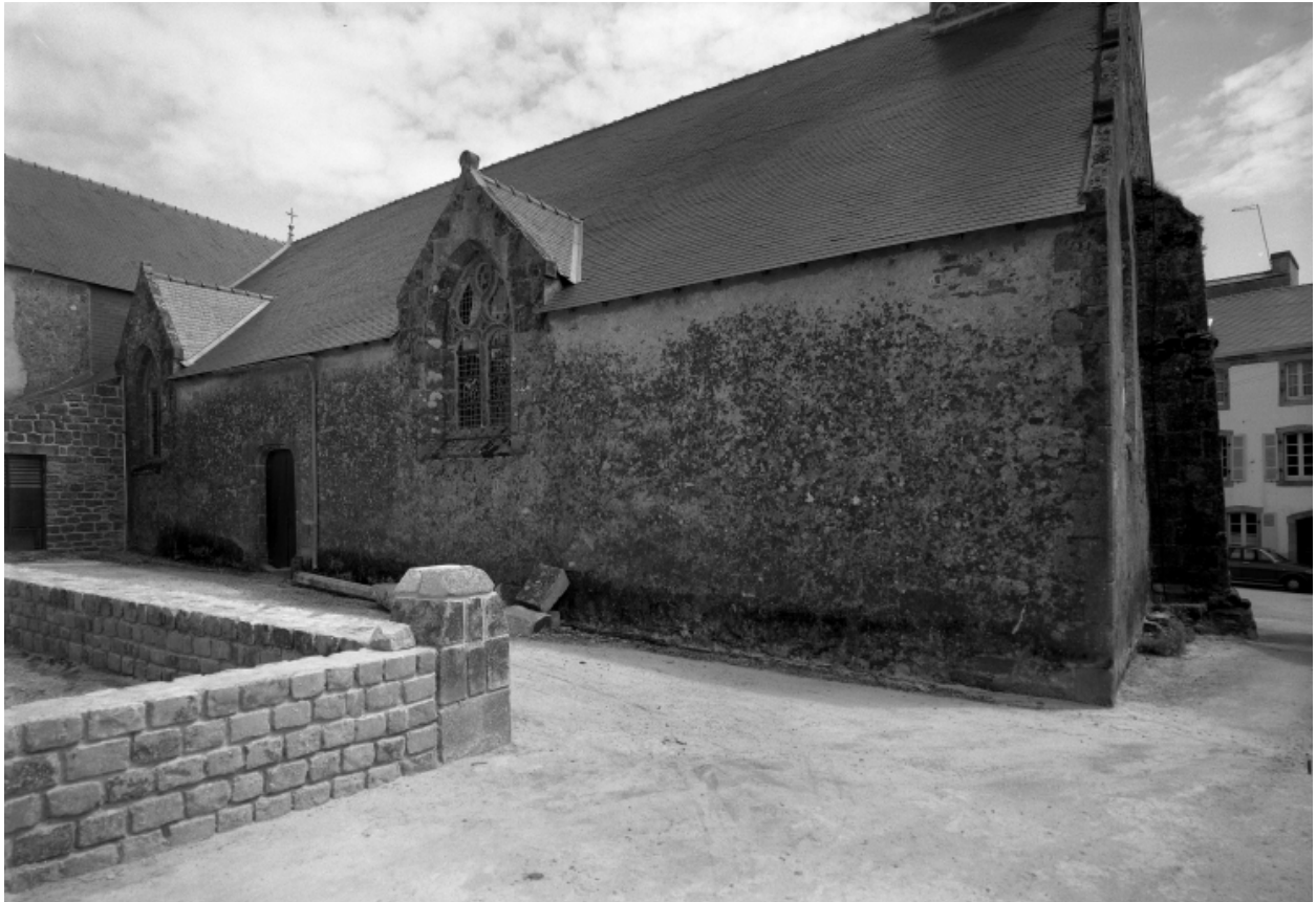
Plomodiern, église paroissiale Saint-Mahouarn : façade nord, mur du bas-côté, état en 1972
