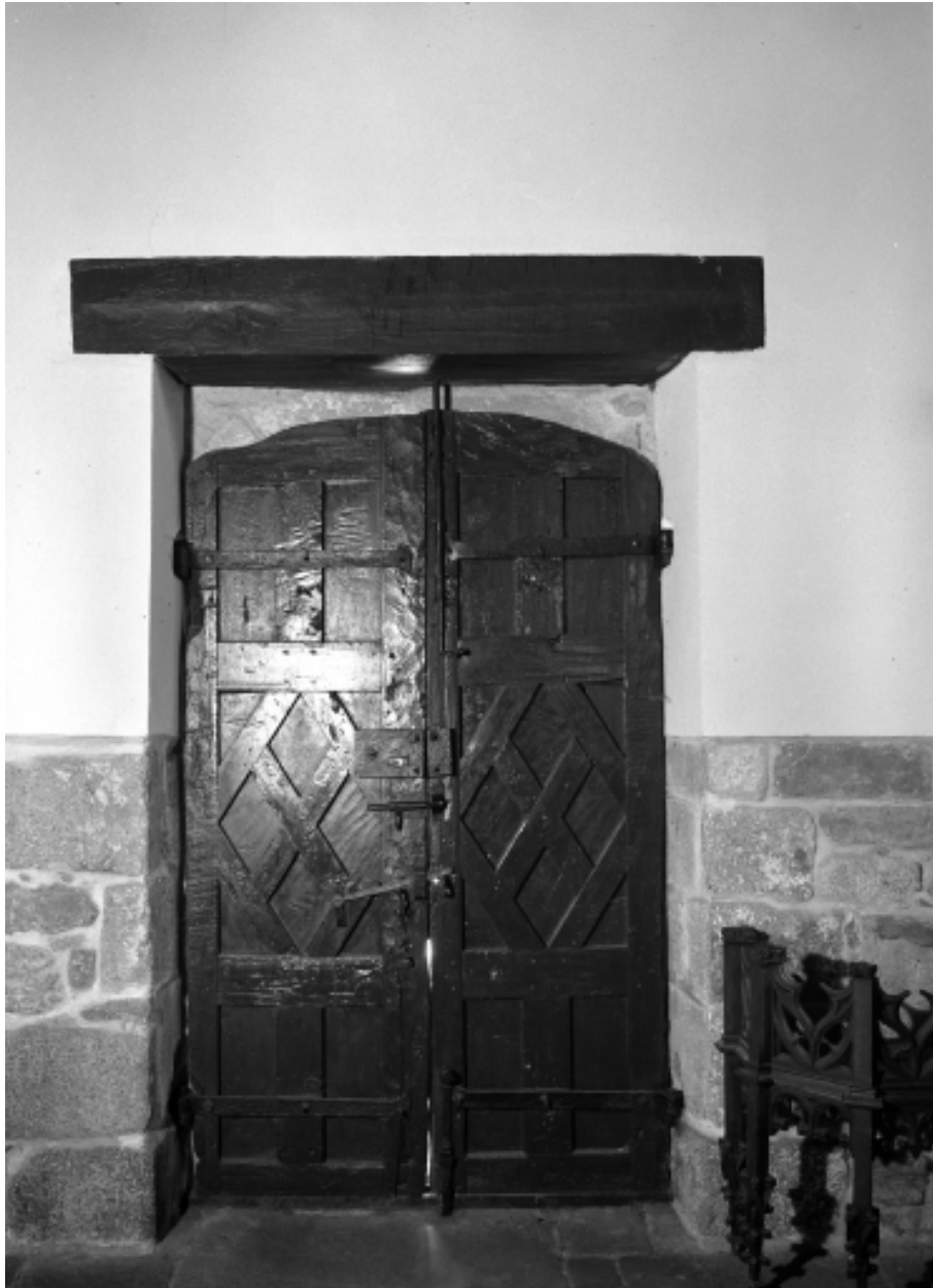
Plomodiern, église paroissiale Saint-Mahouarn : porche sud, vantail de la porte, état en 1970
