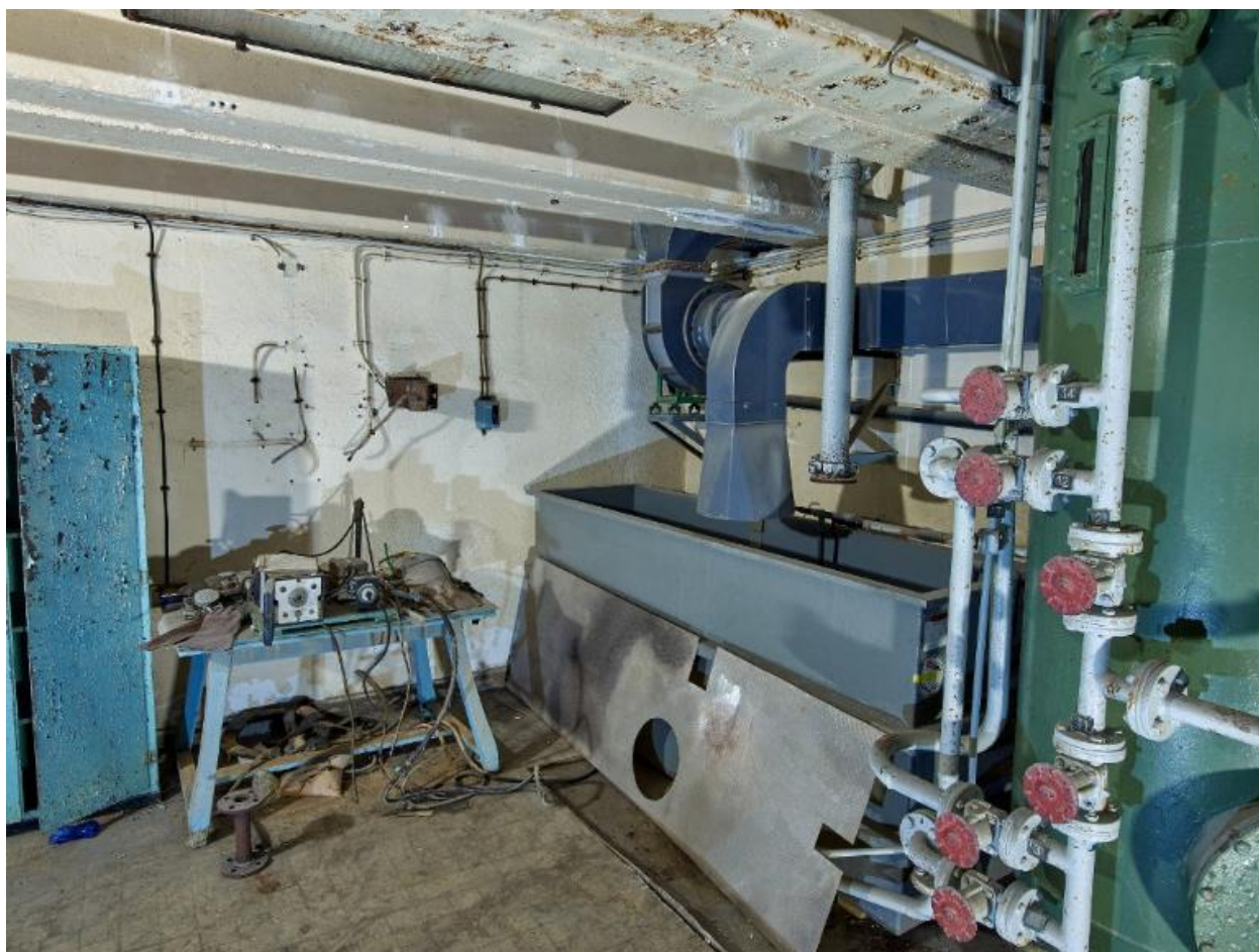
Vue de l'un des deux bacs en résine polyester avec hotte d'aspiration et système de tuyauterie. A gauche, armoire d'atelier et établi. Le plafond est constitué de poutres préfabriquées en béton armé avec avec plafonnier à lampe fluoescence
