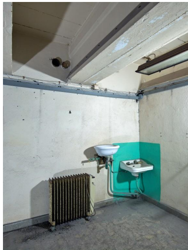
Vue de l'angle nord-est : lavabo et rince-œil muraux. Le plafond est constitué de poutres préfabriquées en béton armé avec plafonnier à lampe fluorescente. A gauche, radiateur électrique Phot. Bernard Bègne IVR53_20235600761NUCA
