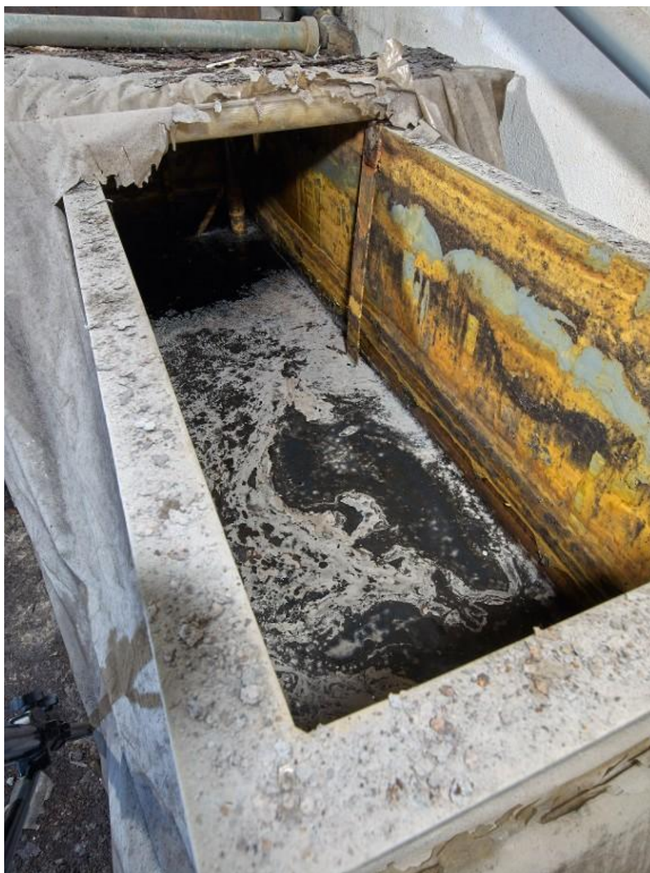
Vue de l'un des deux bacs en résine polyester. Le liquide provient de l'infiltration des eaux pluviales depuis les joints de la dalle de couverture
