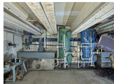
Vue de l'ensemble bacs (avec hottes d'aspiration), chambres et système de tuyauterie. Le plafond est constitué de poutres préfabriquées en béton armé avec avec plafonnier à lampe fluorescente. A gauche, établi Phot. Bernard Bègne IVR53_20235600758NUCA
