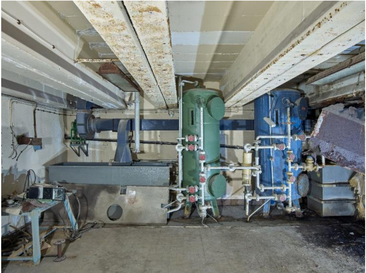
Vue de l'ensemble bacs (avec hottes d'aspiration), chambres et système de tuyauterie. Le plafond est constitué de poutres préfabriquées en béton armé avec avec plafonnier à lampe fluorescente. A gauche, établi
