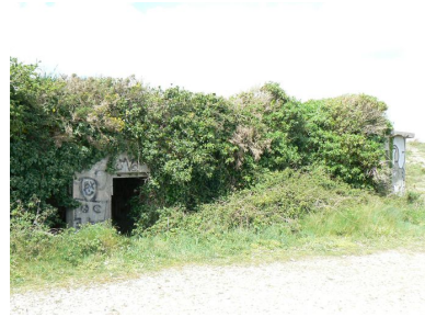
Casemate envahie par la végétation Phot. Lénaïg L'Aot IVR53_20072908561NUCA
