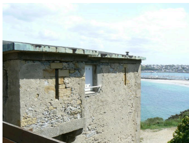
Vue latérale du réduit de batterie de côte du Petit Gouin Phot. Lénaïg L'Aot IVR53_20072908572NUCA
