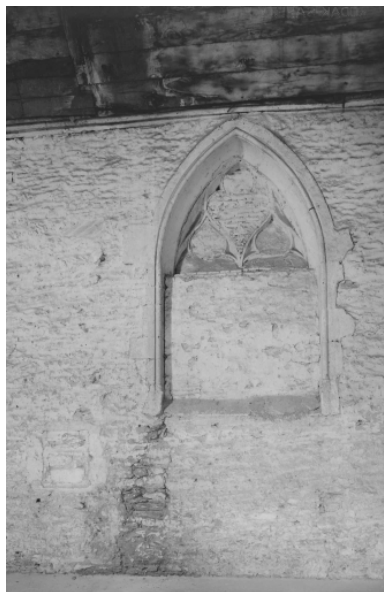
Fenêtre obstruée dans le mur nord du collatéral nord Phot. Isabelle Barbedor IVR53_19693500067V
