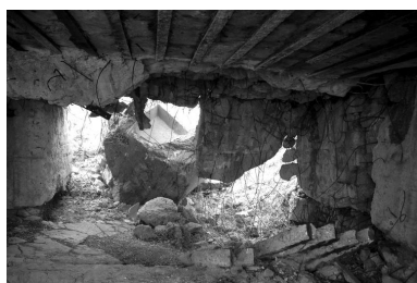
Vue intérieure de l'une des quatre casemates de la batterie de Longues-sur-Mer (casemate est en partie ruinée) Phot. Guillaume Lécueillier IVR53_20051400081NUCA
