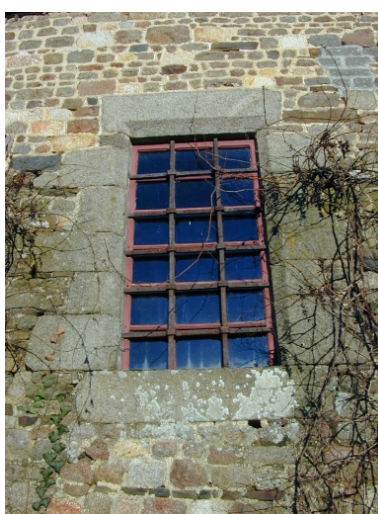
Longère sud, fenêtre de la nef : vue générale Phot. Xavier Gilbert IVR53_20013516956NUCA
