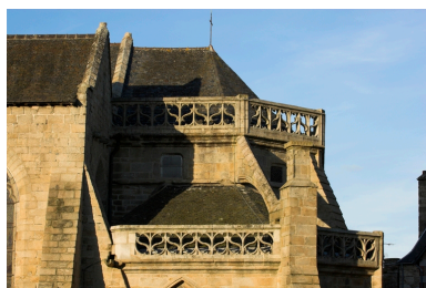
Extérieur, vue des parties hautes du chœur depuis le sud. Phot. Norbert Lambart IVR53_20072200470NUCA
