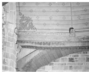
Sablère n°2, bas-côté sud, mur ouest, partie gauche Phot. Guy Artur, Phot. Norbert Lambart IVR53_19832901182X
