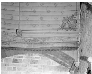
Sablère n°2, bas-côté sud, mur ouest, partie droite Phot. Guy Artur, Phot. Norbert Lambart IVR53_19832901181X
