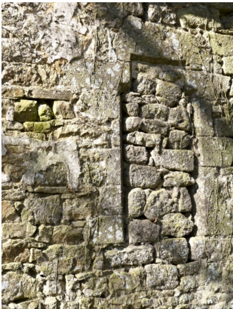
Chambre de Coëtlogon, ancienne fenêtre murée.
