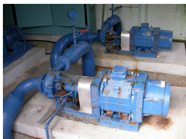
Pompes Rateau et moteurs CEM ; les conduits d'aspiration et de refoulement sont parfaitement reconnaissables.
