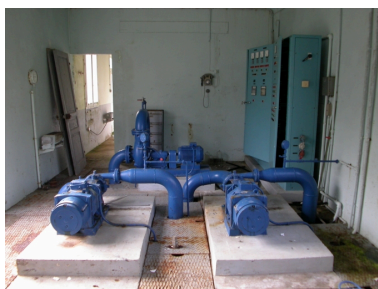
Les pompes centrifuges Rateau du service bas, vue générale.
