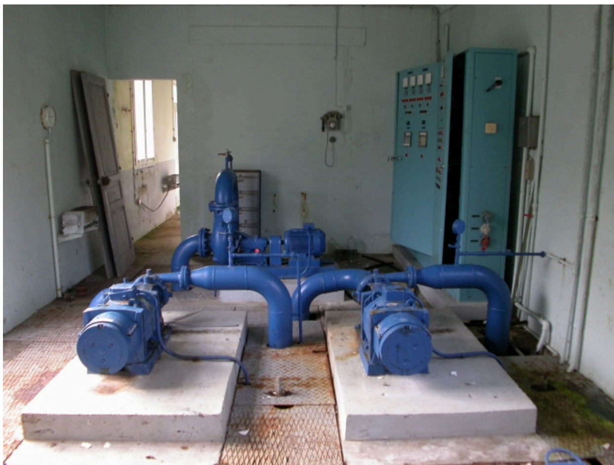
Les pompes centrifuges Rateau du service bas, vue générale.
