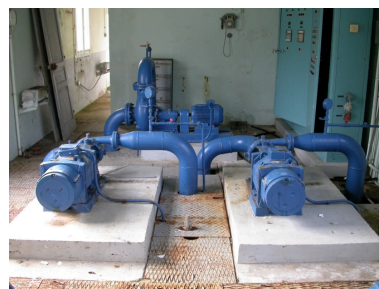
Les pompes du service bas et la pompe de lavage pour les filtres (au fond).
