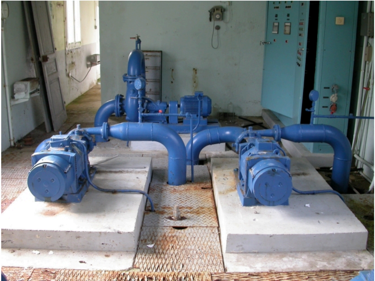
Les pompes du service bas et la pompe de lavage pour les filtres (au fond).
