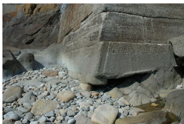
Vue de la batterie basse du Mengant : extrémité ouest ruinée Phot. Guillaume Lécueillier IVR53_20072905827NUCA
