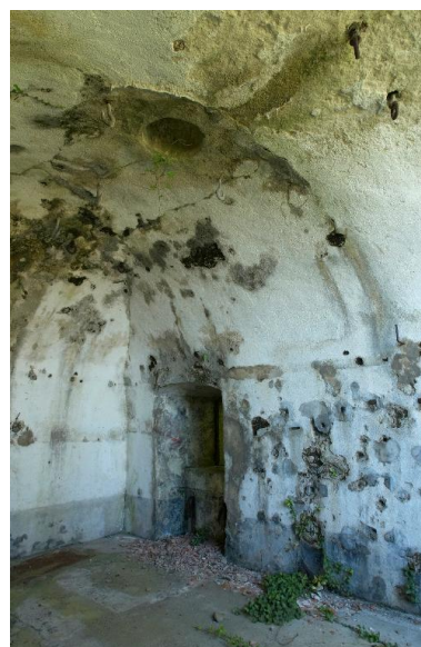
Plouzané : vue du fort du Mengant, usine électrique aménagée à flanc de falaise, intérieur, enduit Phot. Bernard Bègne IVR53_20122901640NUCA
