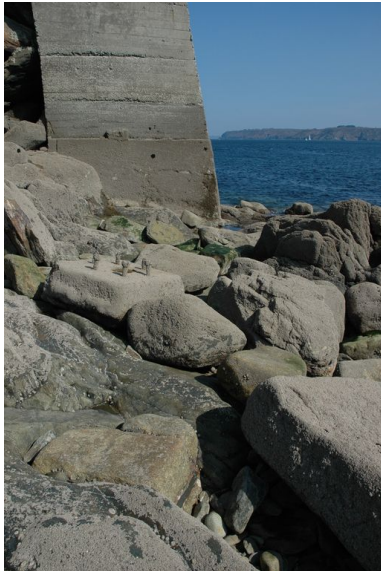
Vue de la batterie basse du Mengant : extrémité ouest ruinée Phot. Guillaume Lécueillier IVR53_20072905835NUCA
