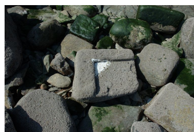
Vue de la batterie basse du Mengant : extrémité ouest ruinée Phot. Guillaume Lécueillier IVR53_20072905849NUCA
