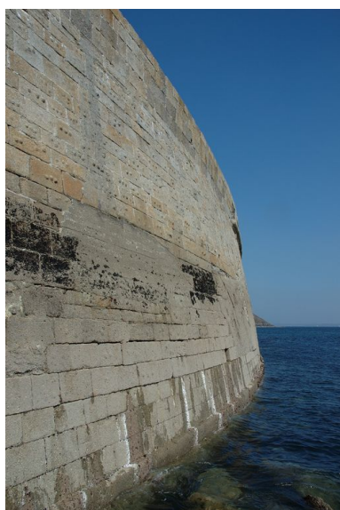
Vue de la batterie basse du Mengant : extrémité ouest ruinée Phot. Guillaume Lécueillier IVR53_20072905847NUCA
