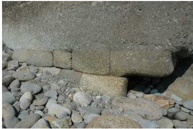
Vue de la batterie basse du Mengant : extrémité ouest ruinée Phot. Guillaume Lécueillier IVR53_20072905832NUCA
