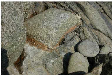
Vue de la batterie basse du Mengant : extrémité ouest ruinée Phot. Guillaume Lécueillier IVR53_20072905838NUCA
