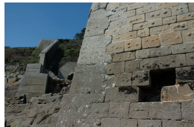
Vue de la batterie basse du Mengant : extrémité ouest ruinée Phot. Guillaume Lécueillier IVR53_20072905840NUCA
