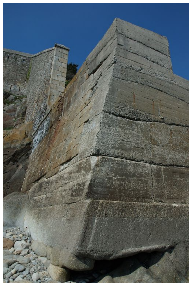
Vue de la batterie basse du Mengant : extrémité ouest ruinée Phot. Guillaume Lécueillier IVR53_20072905826NUCA
