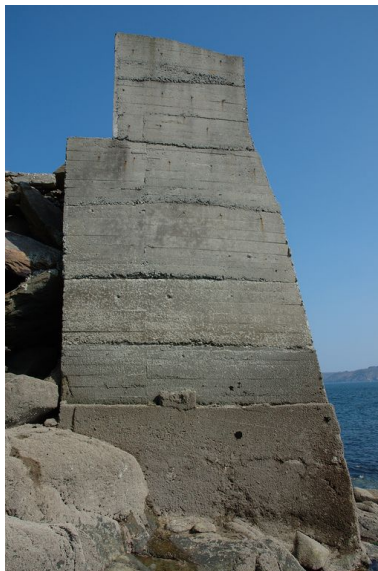
Vue de la batterie basse du Mengant : extrémité ouest ruinée Phot. Guillaume Lécueillier IVR53_20072905839NUCA
