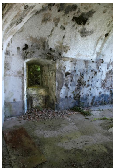
Plouzané : vue du fort du Mengant, usine électrique aménagée à flanc de falaise, intérieur, enduit Phot. Bernard Bègne IVR53_20122901641NUCA
