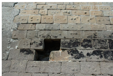
Vue de la batterie basse du Mengant : extrémité ouest ruinée Phot. Guillaume Lécueillier IVR53_20072905844NUCA
