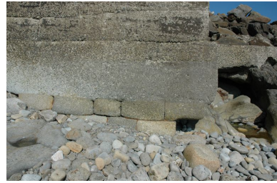
Vue de la batterie basse du Mengant : extrémité ouest ruinée Phot. Guillaume Lécueillier IVR53_20072905831NUCA
