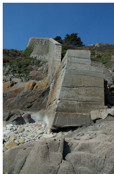
Vue de la batterie basse du Mengant : extrémité ouest ruinée Phot. Guillaume Lécueillier IVR53_20072905825NUCA
