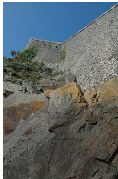
Vue de la batterie basse du Mengant : extrémité ouest ruinée Phot. Guillaume Lécueillier IVR53_20072905828NUCA
