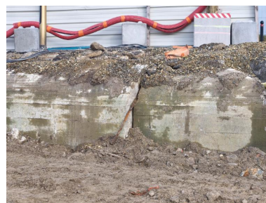
Vue depuis le sud-ouest : au centre, la fracture du bunker (couverture photographique du 22 janvier 2026). Sur la dalle de couverture du bunker passe la chaussée Éric Tabarly Phot. Bernard Bègne IVR53_20263500062NUCA
