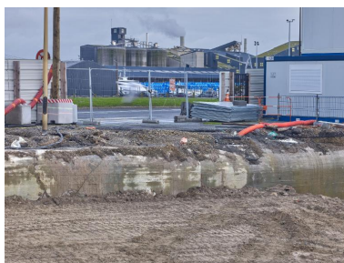
Vue depuis l'ouest : au centre, la fracture du bunker (couverture photographique du 22 janvier 2026). Sur la dalle de couverture du bunker passe la chaussée Éric Tabarly Phot. Bernard Bègne IVR53_20263500061NUCA
