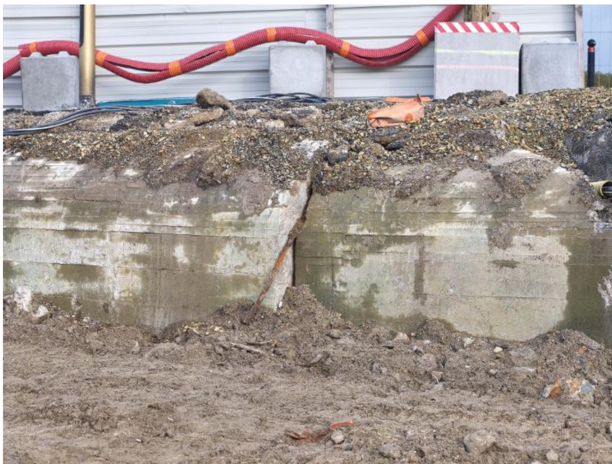
Vue depuis le sud-ouest : au centre, la fracture du bunker (couverture photographique du 22 janvier 2026). Sur la dalle de couverture du bunker passe la chaussée Éric Tabarly
