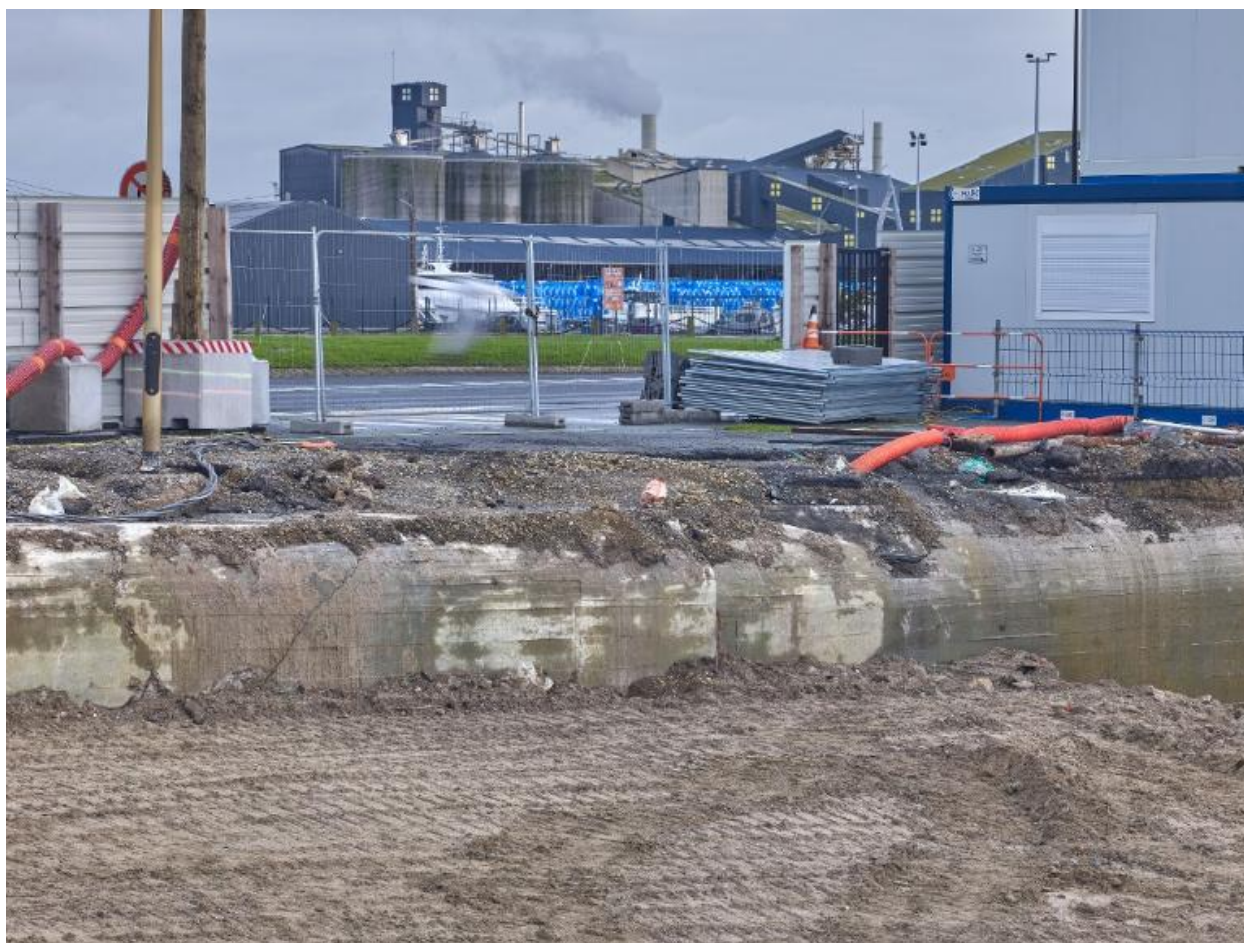
Vue depuis l'ouest : au centre, la fracture du bunker (couverture photographique du 22 janvier 2026). Sur la dalle de couverture du bunker passe la chaussée Éric Tabarly
