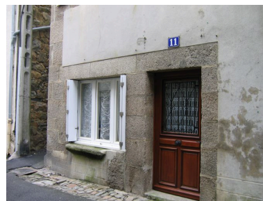
Maison n° 11 rue de Reims, détail : porte et baie avec étal Phot. Françoise Péron IVR53_20062908413NUCA
