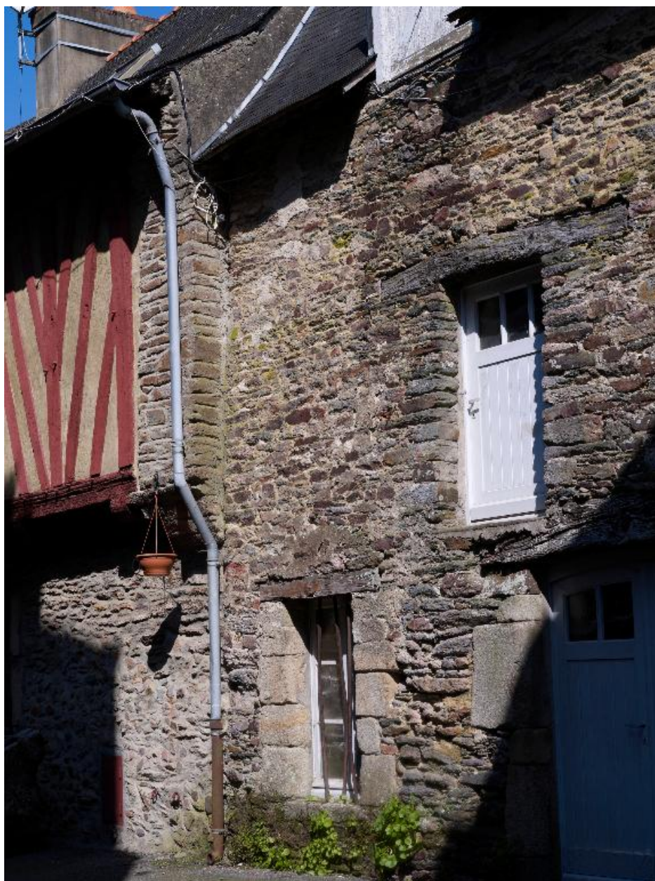
Maison : mur latéral formant un léger renflement à partir du 1er étage, pour contenir le pan de bois qui avance (état en 2012)
