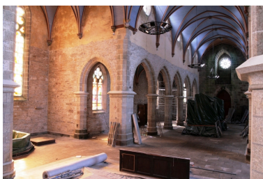
Hanvec, église paroissiale Saint- Pierre : vue transversale sud-ouest Phot. Gwénaél Fauchille IVR53_20082905731NUCA
