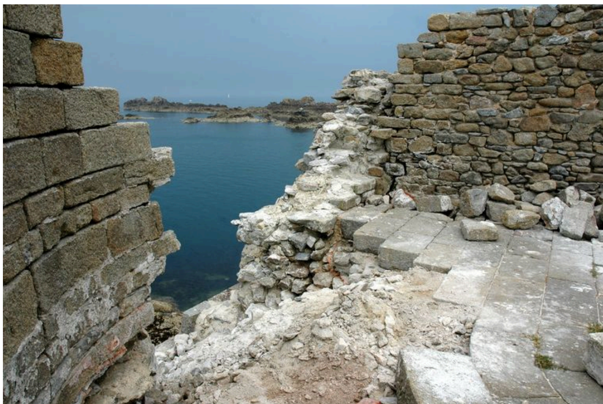
Vue du fort de la Conchée : parapet sud et dallage de la terrasse en cours de restauration
