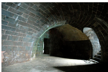
Vue du fort de la Conchée : logement dit souterrain à deux baies Phot. Guillaume Lécueillier IVR53_20063517562NUCA
