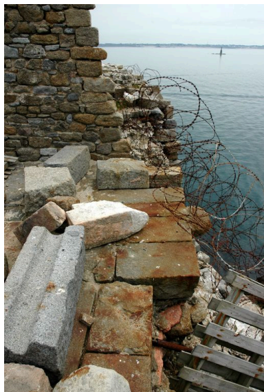
Vue du fort de la Conchée : parapet sud et dallage de la terrasse en cours de restauration Phot. Guillaume Lécueillier IVR53_20063517599NUCA
