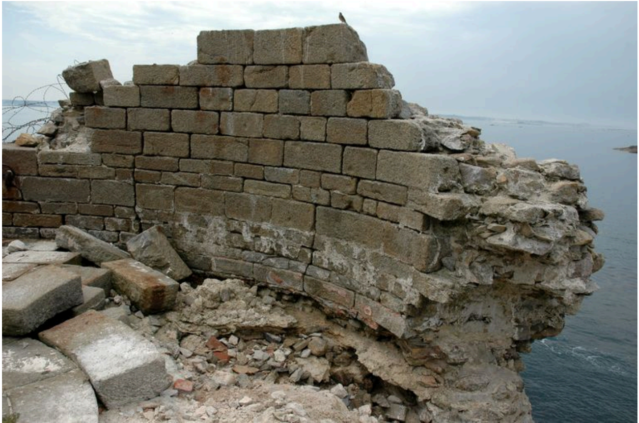
Vue du fort de la Conchée : parapet sud et dallage de la terrasse en cours de restauration
