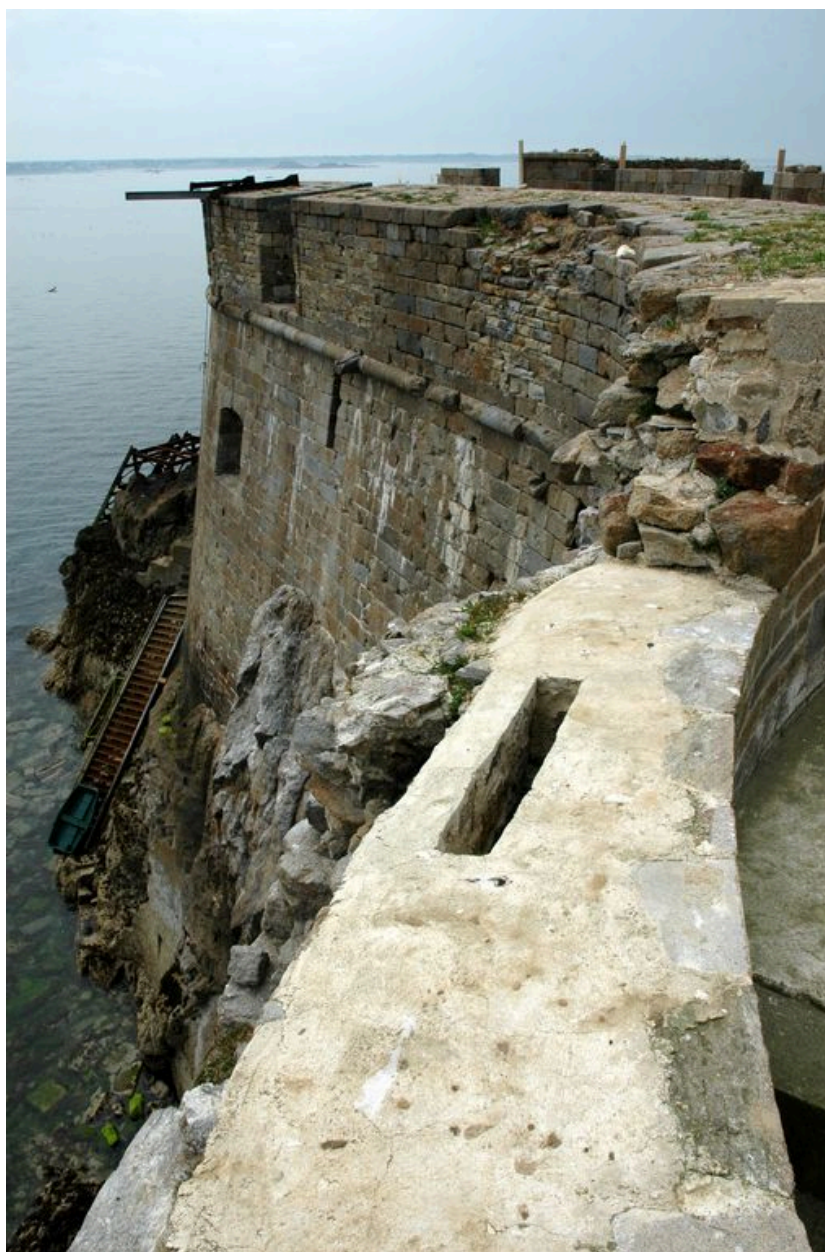
Vue du fort de la Conchée : parapet de la plate-forme d'artillerie (batterie haute). Au premier plan : évent d'aération d'une des casemates
