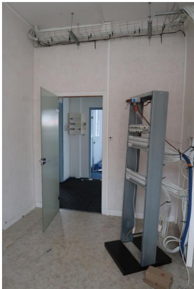
Intérieur, 1er étage, local des baies informatiques Phot. Erwana L'Haridon IVR53_20212905762NUCA
