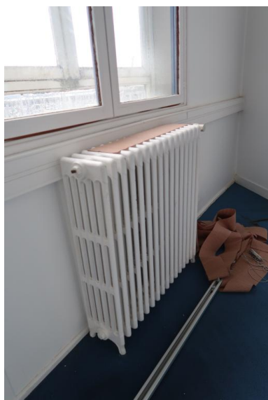
Intérieur, 1er étage, radiateur en fonte Phot. Erwana L'Haridon IVR53_20212905765NUCA
