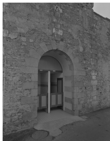
Elévation Est, porte : vue générale Phot. Bernard Bègne, Phot. M. Loyon IVR53_19933500370X
