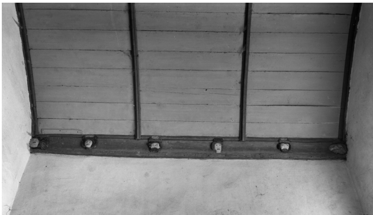
Plonévez-du-Faou, église paroissiale Saint-Pierre : sablière, porche sud, mur ouest, état en 1967
