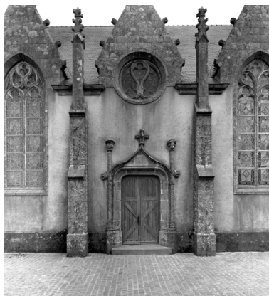
Plonévez-Porzay, église paroissiale Saint-Miliau : façade nord, détail 3ème travée, état en 1970 Phot. Guy Artur IVR53_19702900945V
