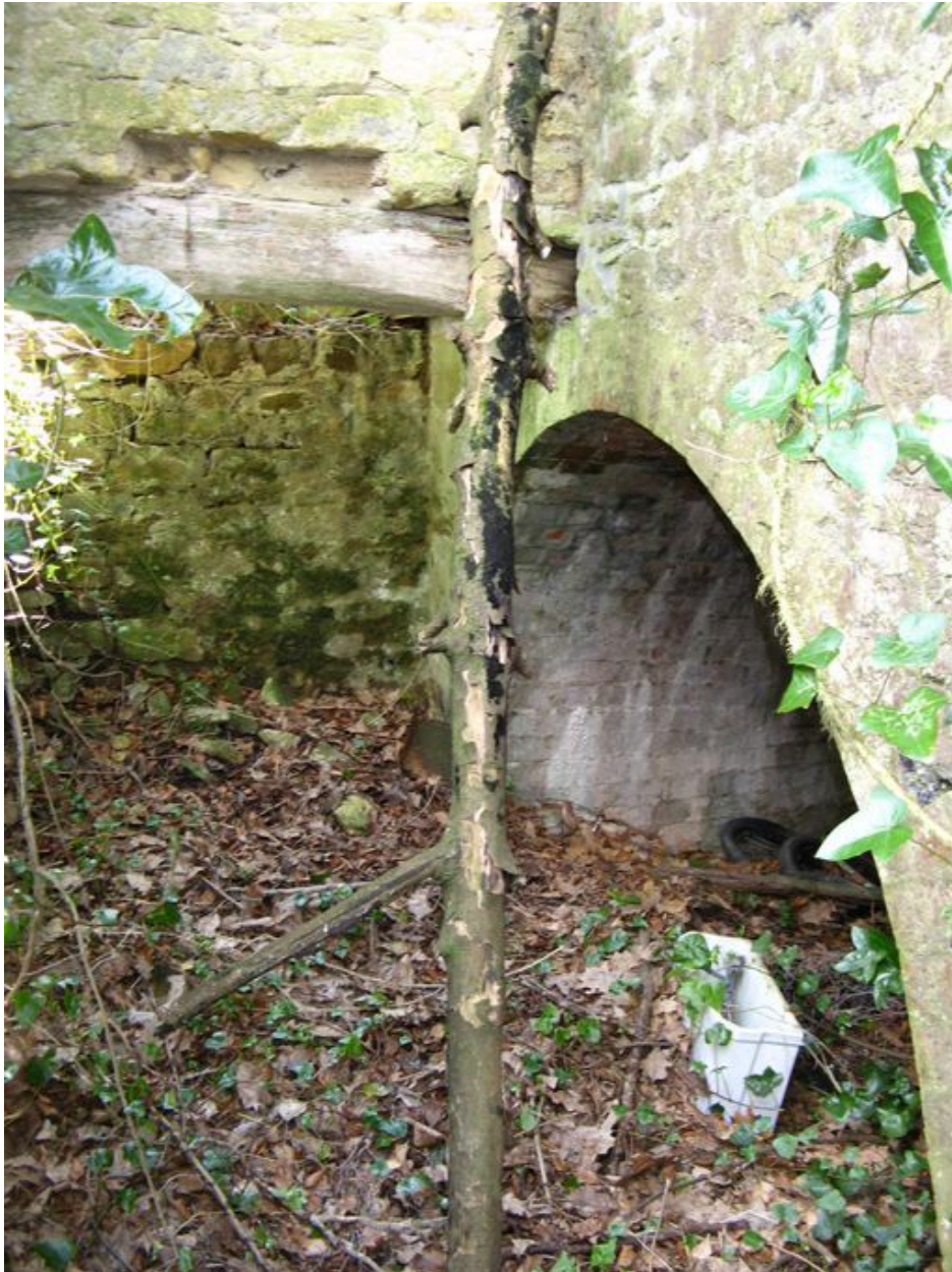
Four à chaux sur le terrain de la briqueterie Kermarec
