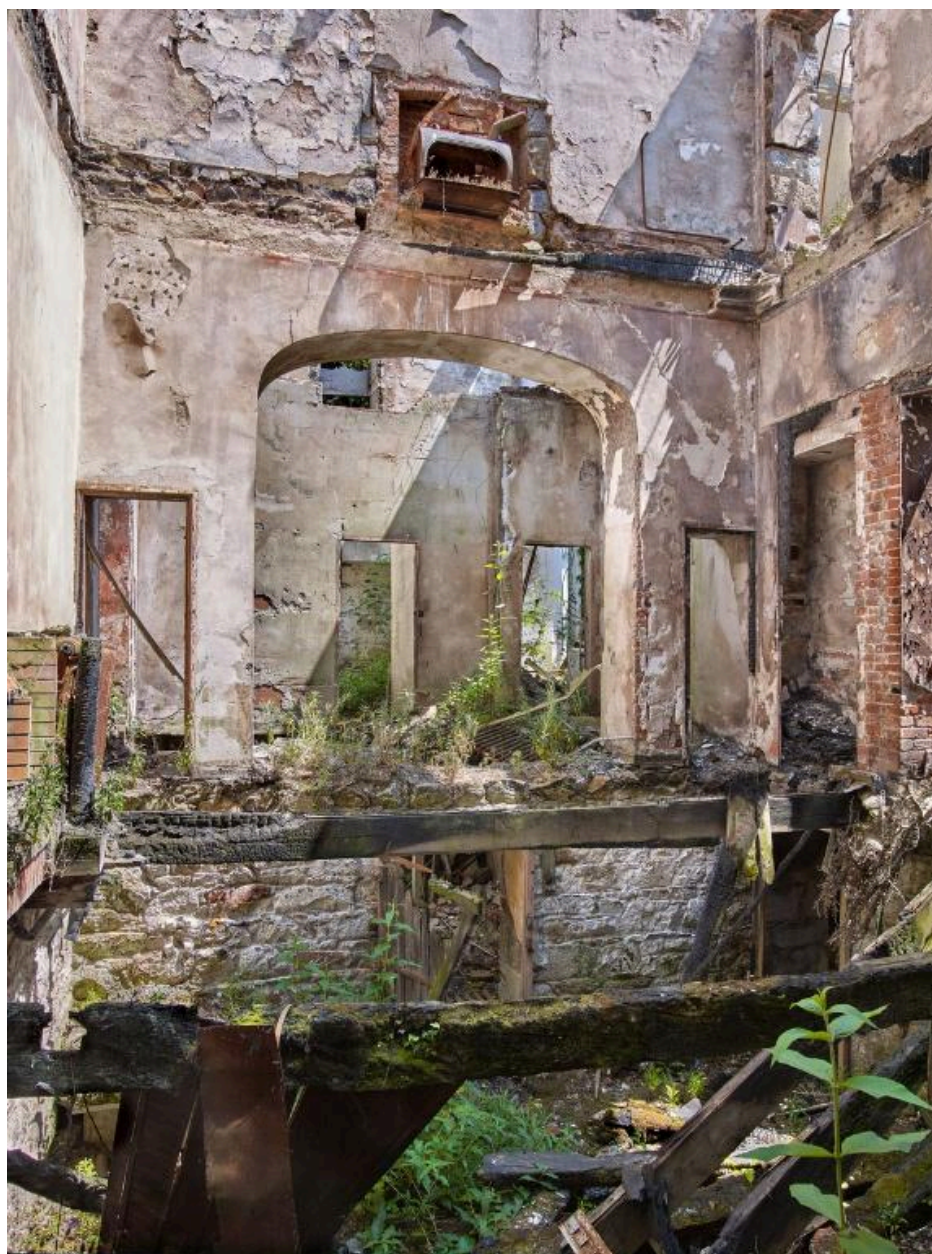
Vue intérieure : salle située au Nord-ouest, mur de refend percé d'ouvertures. Les planchers ont cédé lors de l'incendie laissant apparaître le sous-sol. A l'étage, un poêle est resté en place dans sa cheminée
