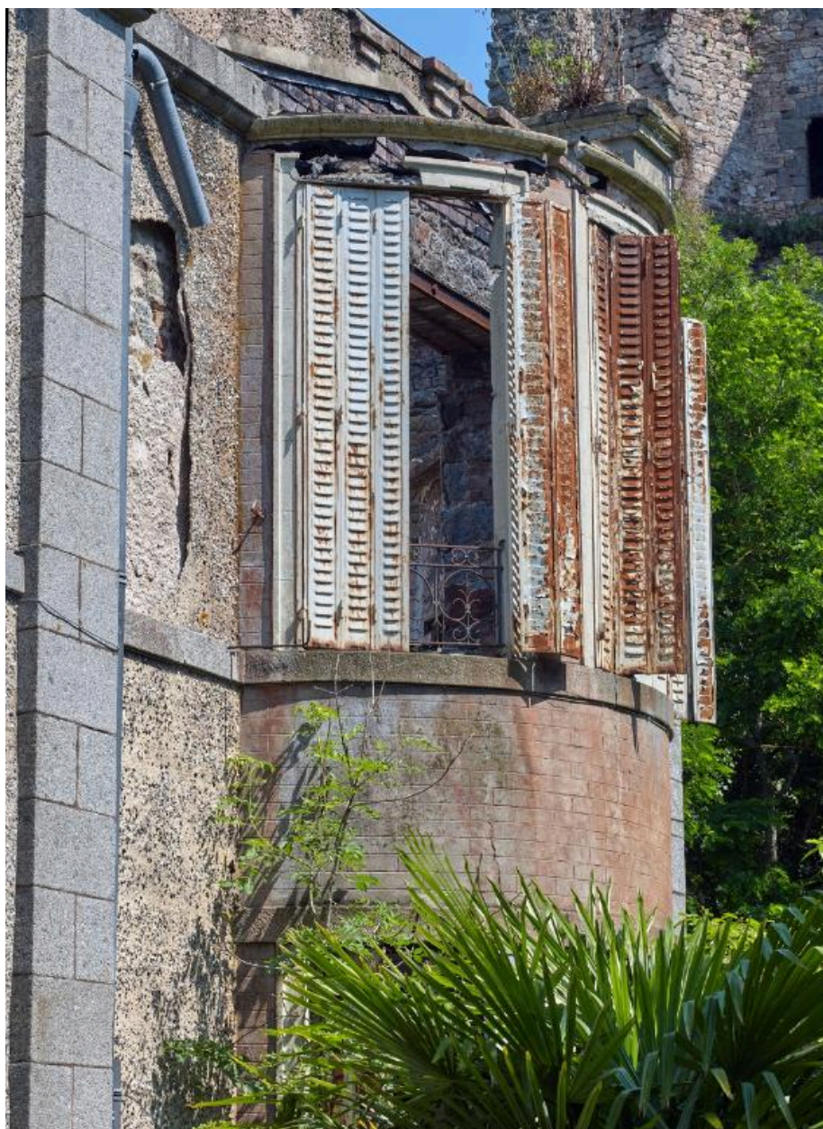
Vue de l'élévation Sud-est : fenêtre en encorbellement (bow-window) du premier étage. Les volets métalliques sont toujours en place après l'incendie
