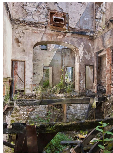
Vue intérieure : salle située au Nord-ouest, mur de refend percé d'ouvertures. Les planchers ont cédé lors de l'incendie laissant apparaître le sous-sol. A l'étage, un poêle est resté en place dans sa cheminée Phot. Bernard Bègne IVR53_20232200474NUCA
