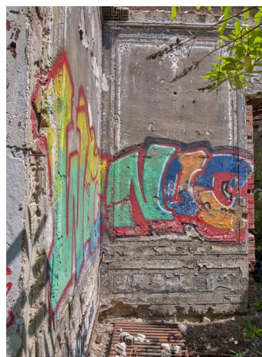
Vue intérieure : traces des boiseries recouvertes de graffiti
