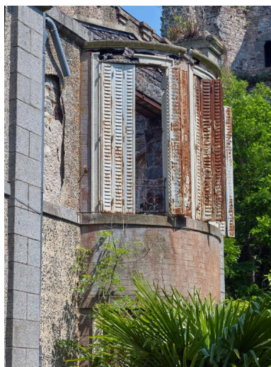
Vue de l'élévation Sud-est : fenêtre en encorbellement (bow-window) du premier étage. Les volets métalliques sont toujours en place après l'incendie Phot. Bernard Bègne IVR53_20232200468NUCA
