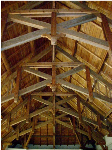
Ploudalmézeau, église de Portsall : détail de la charpente apparente de la nef Phot. Gwénaél Fauchille IVR53_20082906174NUCA
