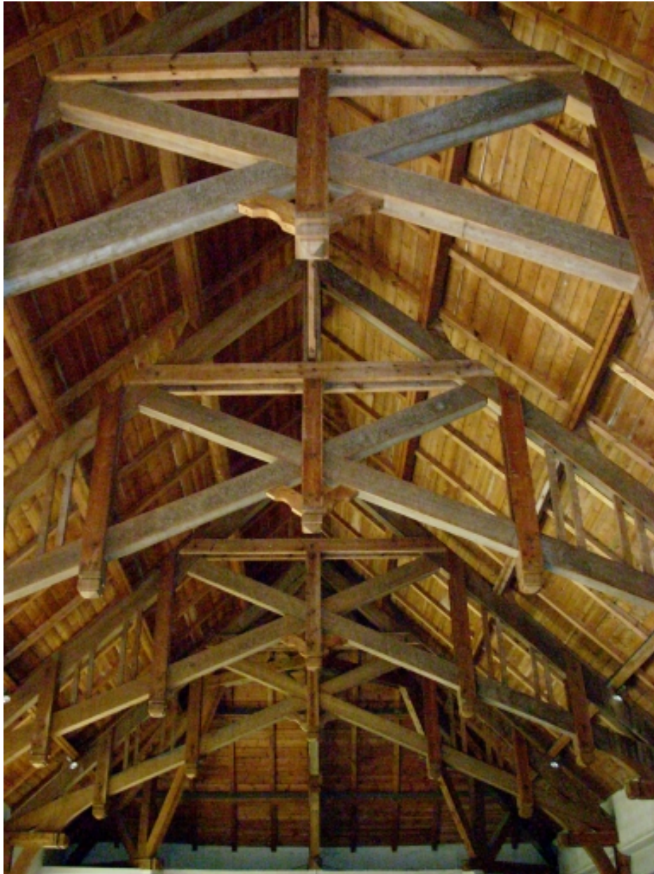
Ploudalmézeau, église de Portsall : détail de la charpente apparente de la nef
