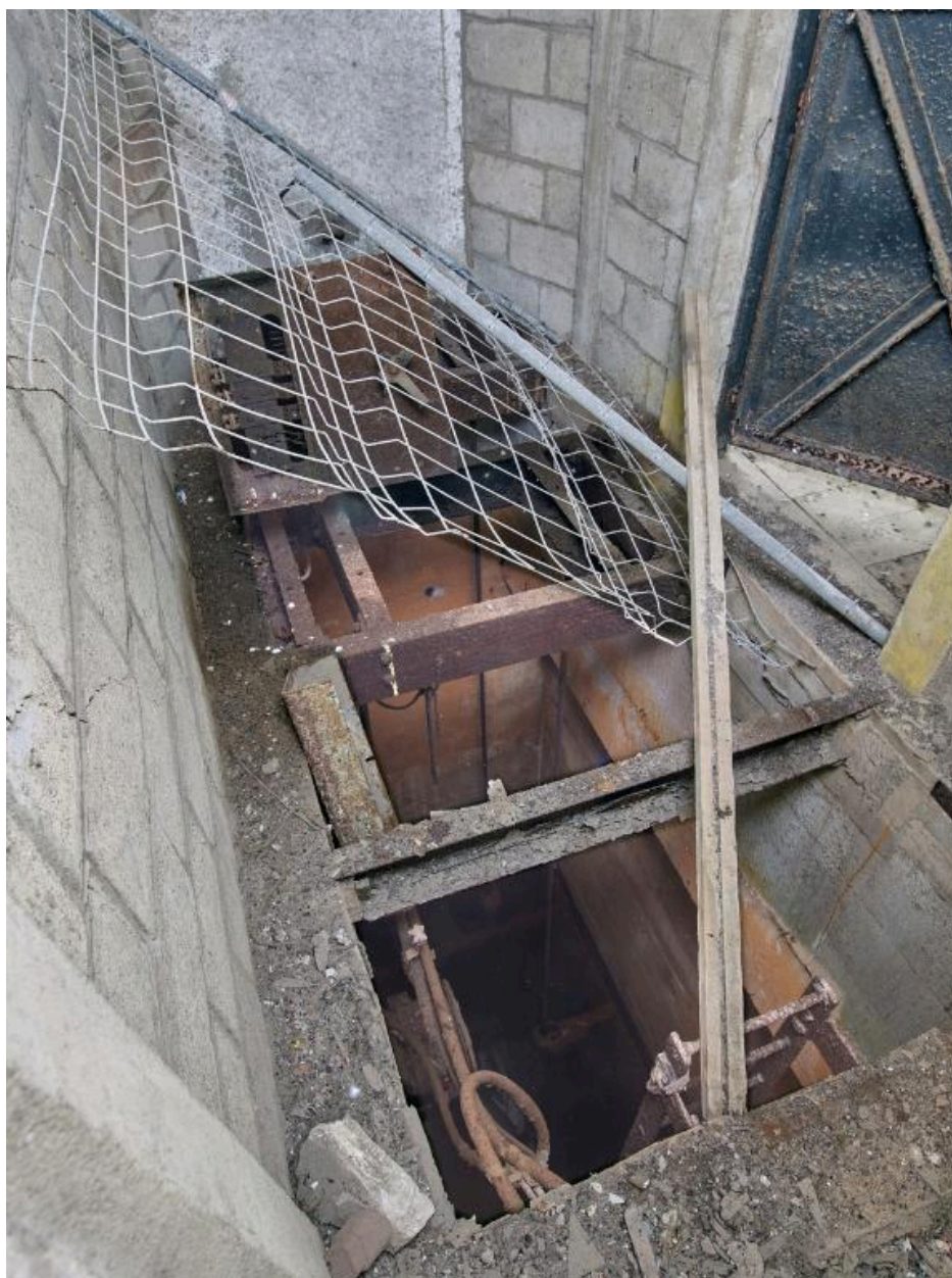
Vue de la salle des pompes de l'alvéole D (quai n° 19) aménagée dans l'épaisseur du mur de refend : fosse technique en sous-sol au niveau des commandes des pompes
