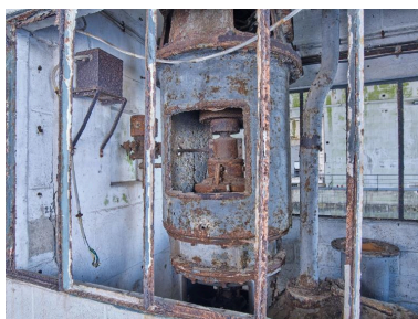
Vue de la salle des pompes située entre les alvéoles D (n ° 19, 19a et 20) et E (n° 17 et 18) Phot. Bernard Bègne IVR53_20235600086NUCA
