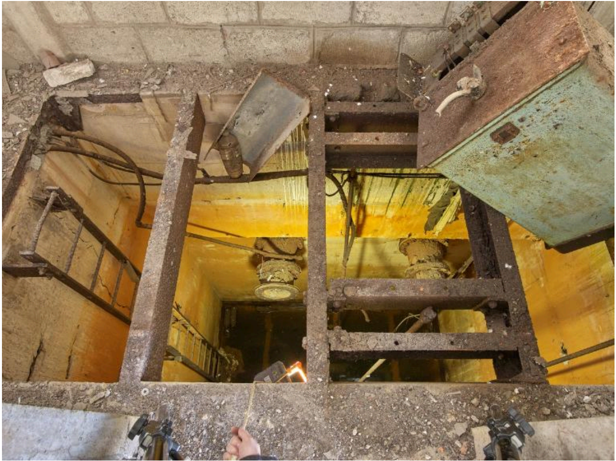
Vue de la salle des pompes de l'alvéole D (quai n° 19) aménagée dans l'épaisseur du mur de refend : fosse technique en sous-sol au niveau des commandes des pompes
