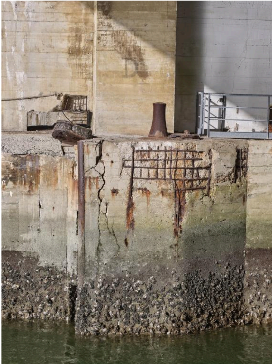
Vue de l'entrée de l'alvéole : quai ouest n° 20 avec cabestan. A signaler : la fixation haute de la porte d'écluse endommagée et la corrosion avancée des fers à béton
