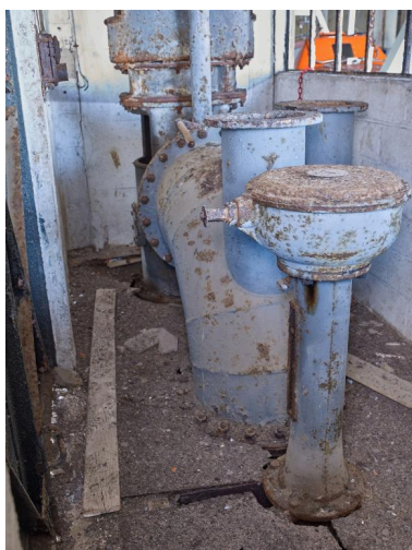
Vue de la salle des pompes située entre les alvéoles D (n ° 19, 19a et 20) et E (n° 17 et 18) : l'un des tuyaux a été déposé Phot. Bernard Bègne IVR53_20235600084NUCA
