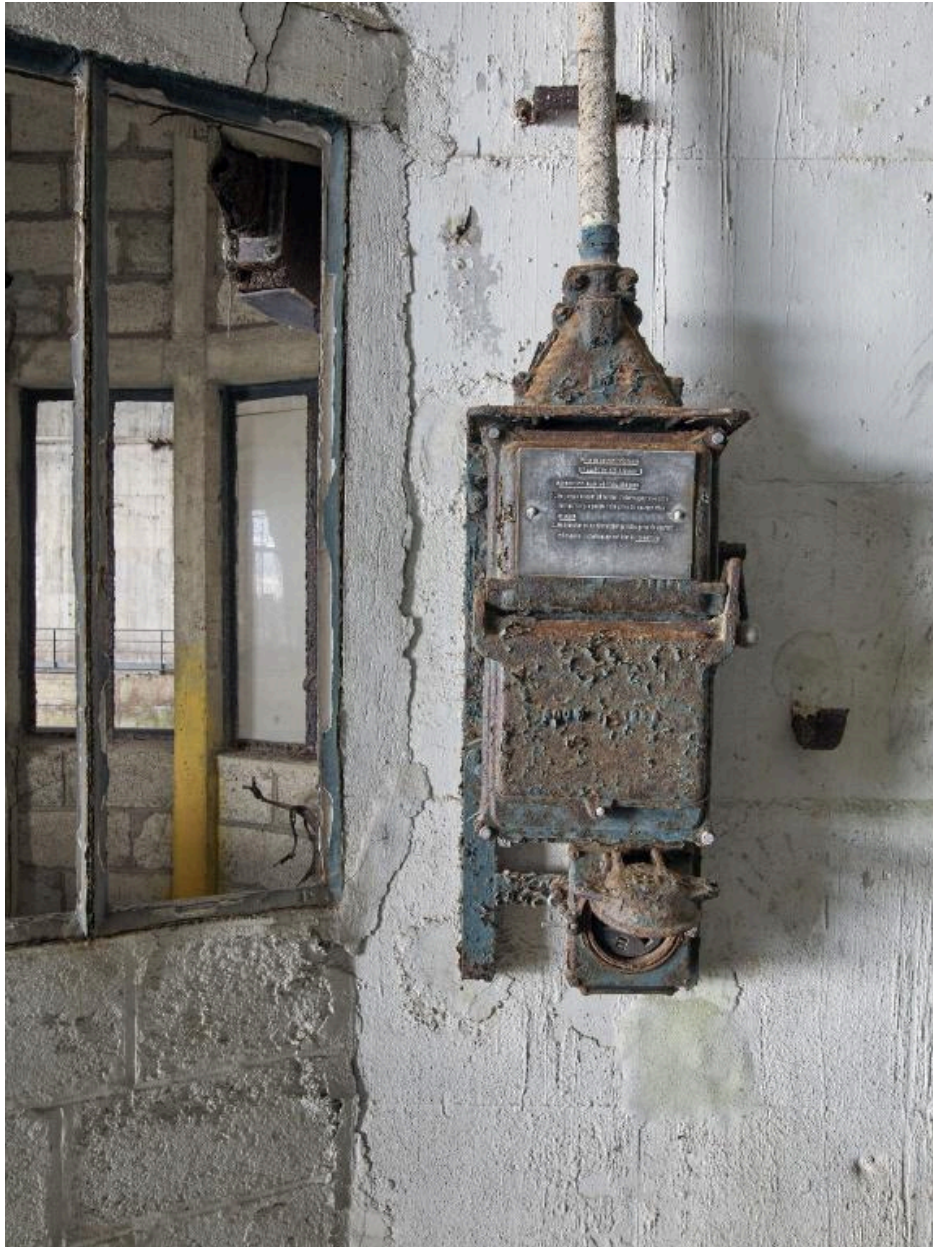
Vue du boîtier (fermé) de l'une des prises électriques triphasées du bassin D. Sur le boîtier : informations ("115 v 60 Hz 125 A Bassin D") et consignes de sécurité
