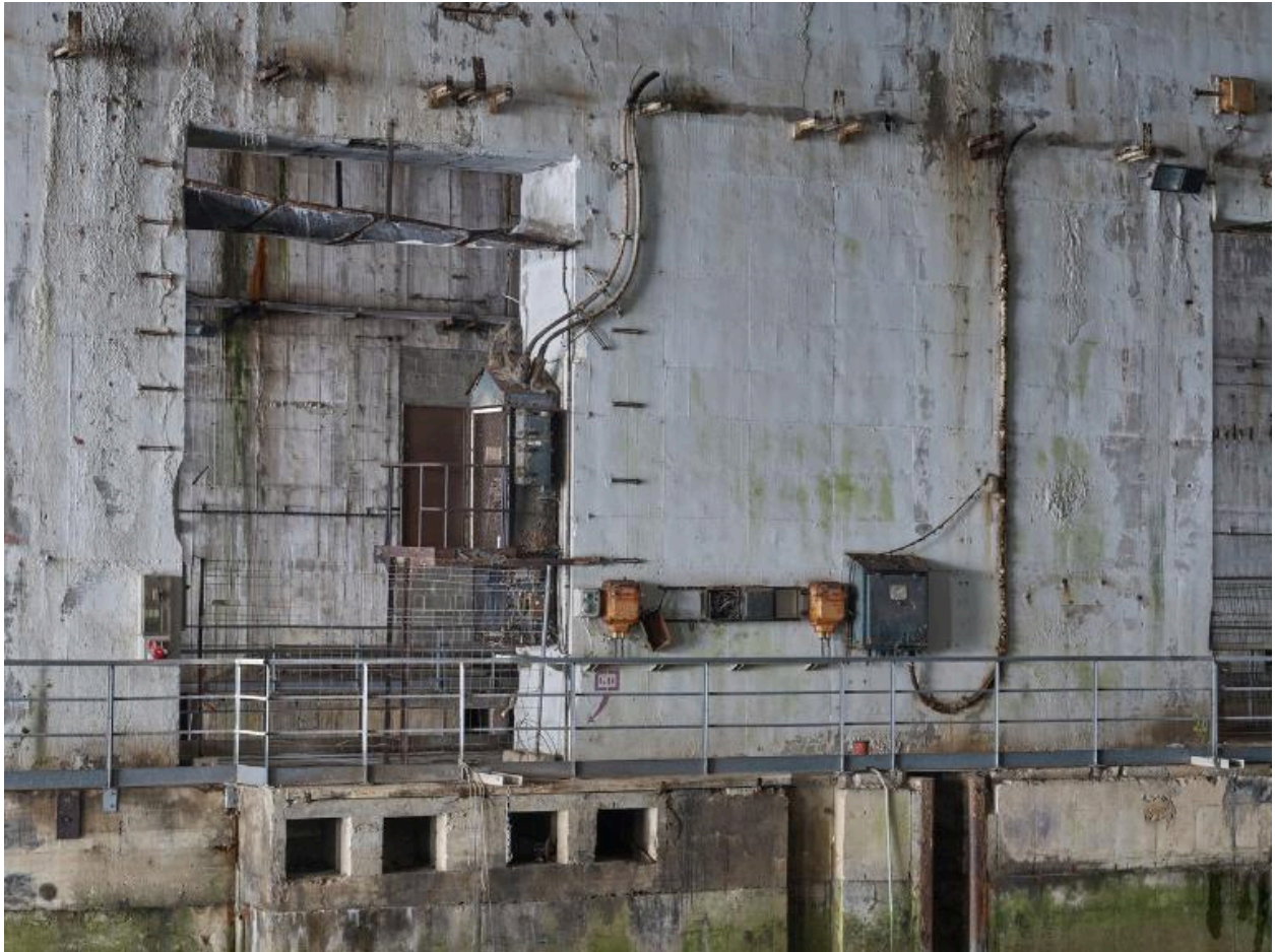
Vue du mur de refend situé entre les alvéoles C et D (quai n° 20) : sur les murs, les installations électriques
