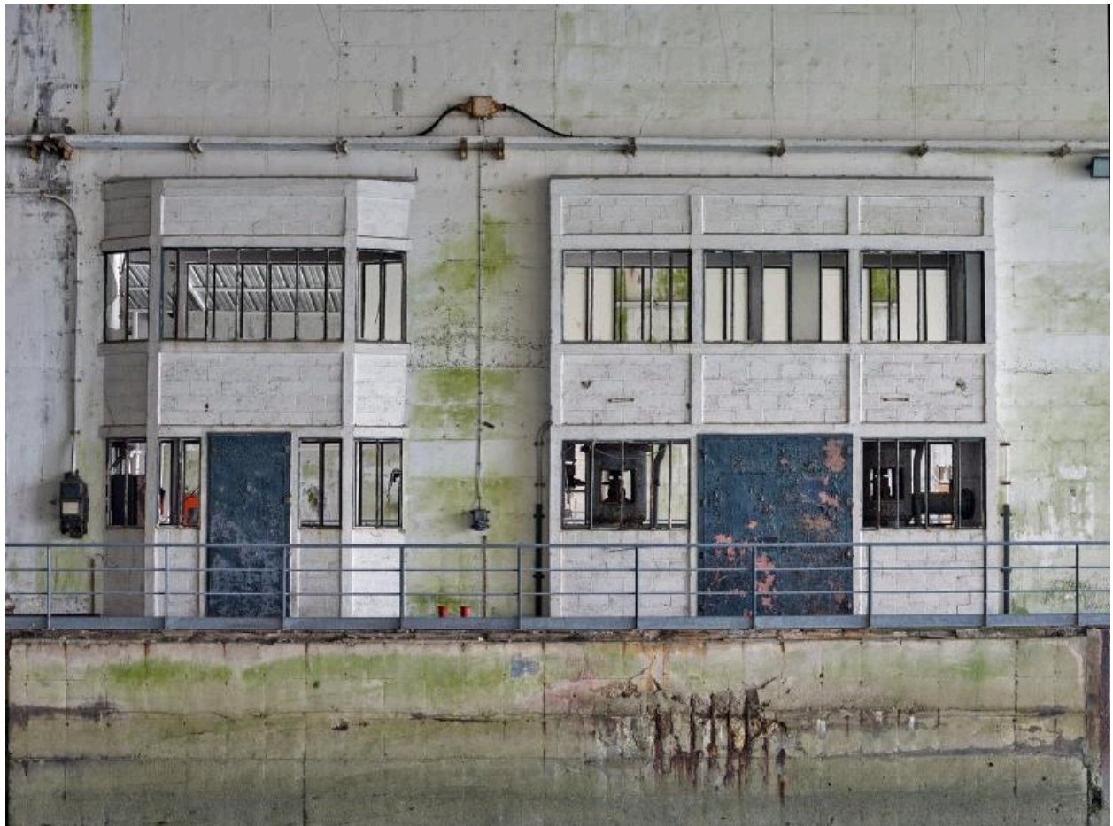
Vue générale des salles des pompes aménagées dans l'épaisseur du mur de refend entre les alvéoles D et E. Au premier plan, le quai n° 19
