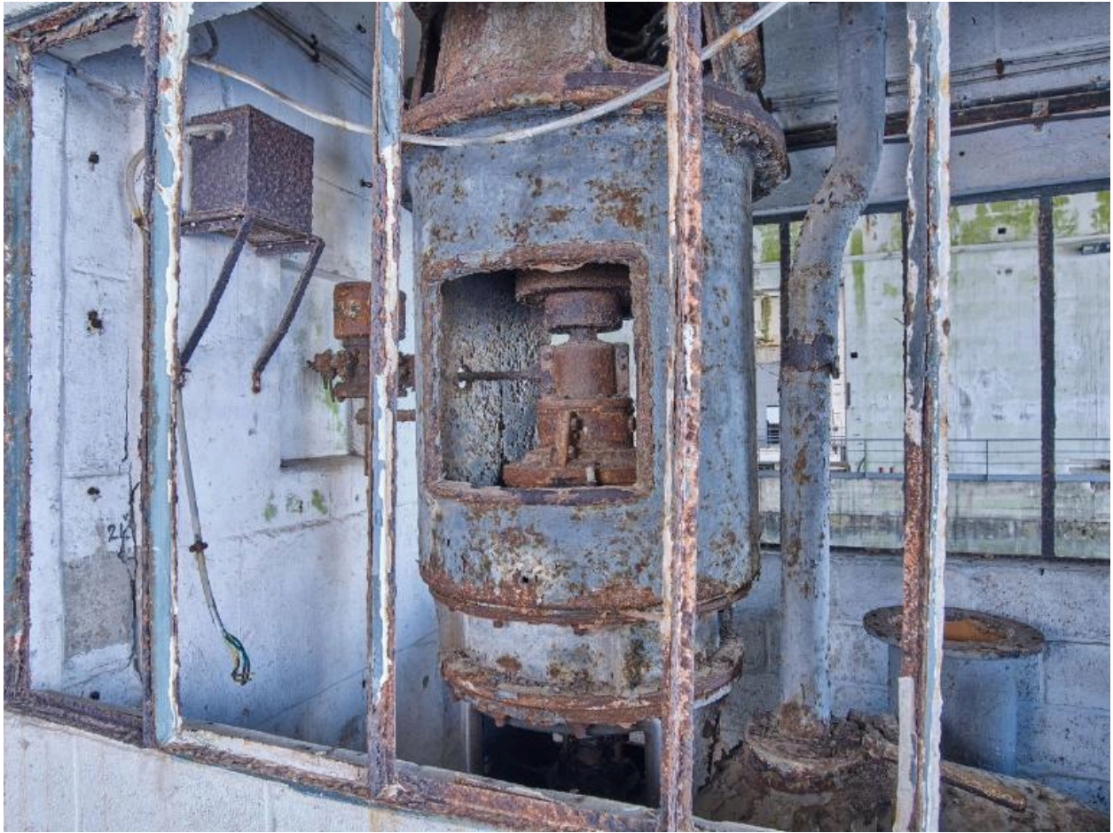
Vue de la salle des pompes située entre les alvéoles D (n° 19, 19a et 20) et E (n° 17 et 18)
