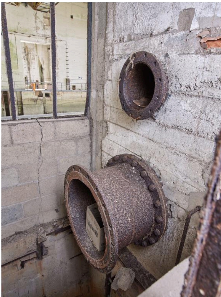
Vue de la salle des pompes de l'algéole D (quai n° 19) aménagée dans l'épaisseur du mur de refend : fosse technique en sous-sol
