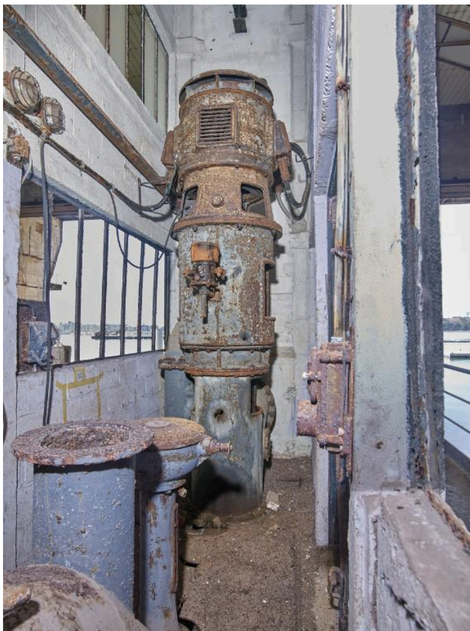
Vue de la salle des pompes située entre les alvéoles D (n° 19, 19a et 20) et E (n° 17 et 18)
