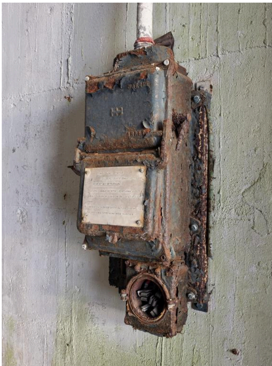
Vue du boîtier (fermé) de l'une des prises électriques triphasées du bassin D (tribord). Sur le boîtier : informations ("115 V 60 HZ 125 Amp - Bassin D - (tribord)") et consignes de sécurité
