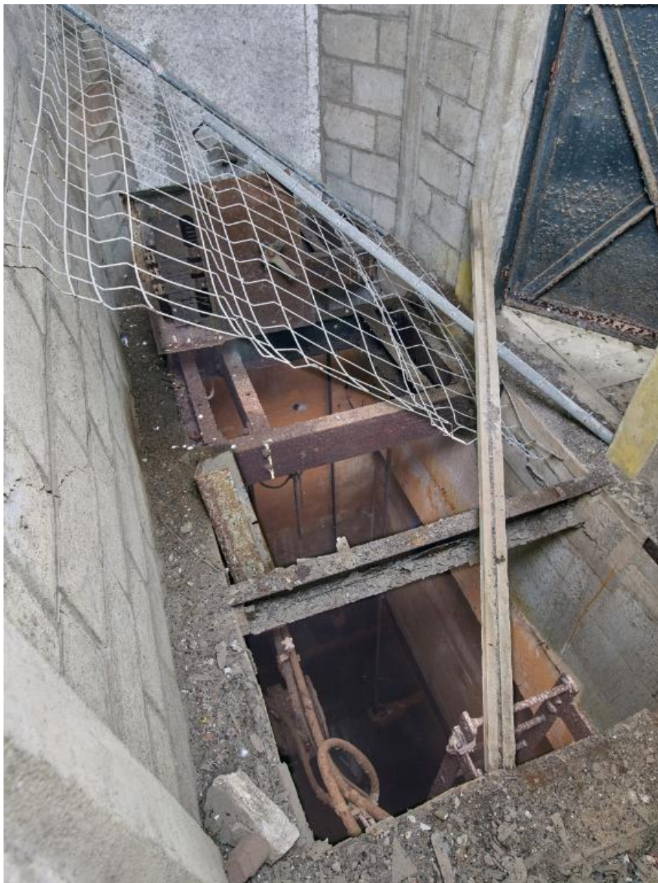
Vue de la salle des pompes de l'algéole D (quai n° 19) aménagée dans l'épaisseur du mur de refend : fosse technique en sous-sol au niveau des commandes des pompes
