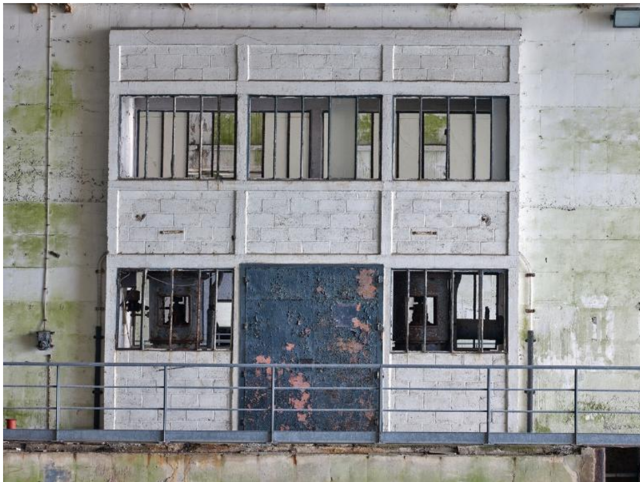
Vue de la salle des pompes aménagée dans l'épaisseur du mur de refend entre les alvéoles D et E. Au premier plan, le quai n° 19
