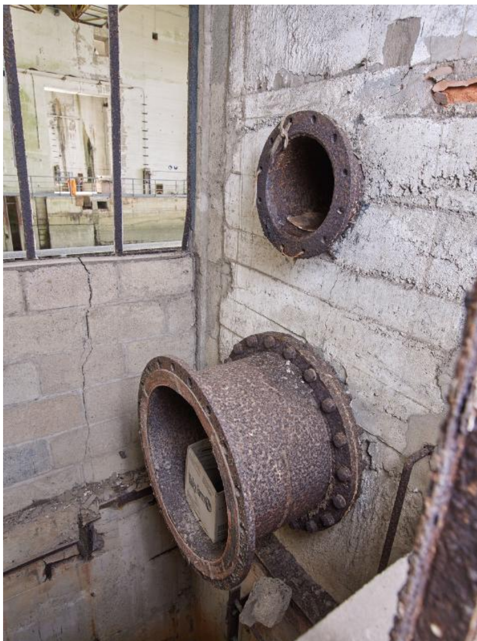
Vue de la salle des pompes de l'alvéole D (quai n° 19) aménagée dans l'épaisseur du mur de refend : fosse technique en sous-sol
