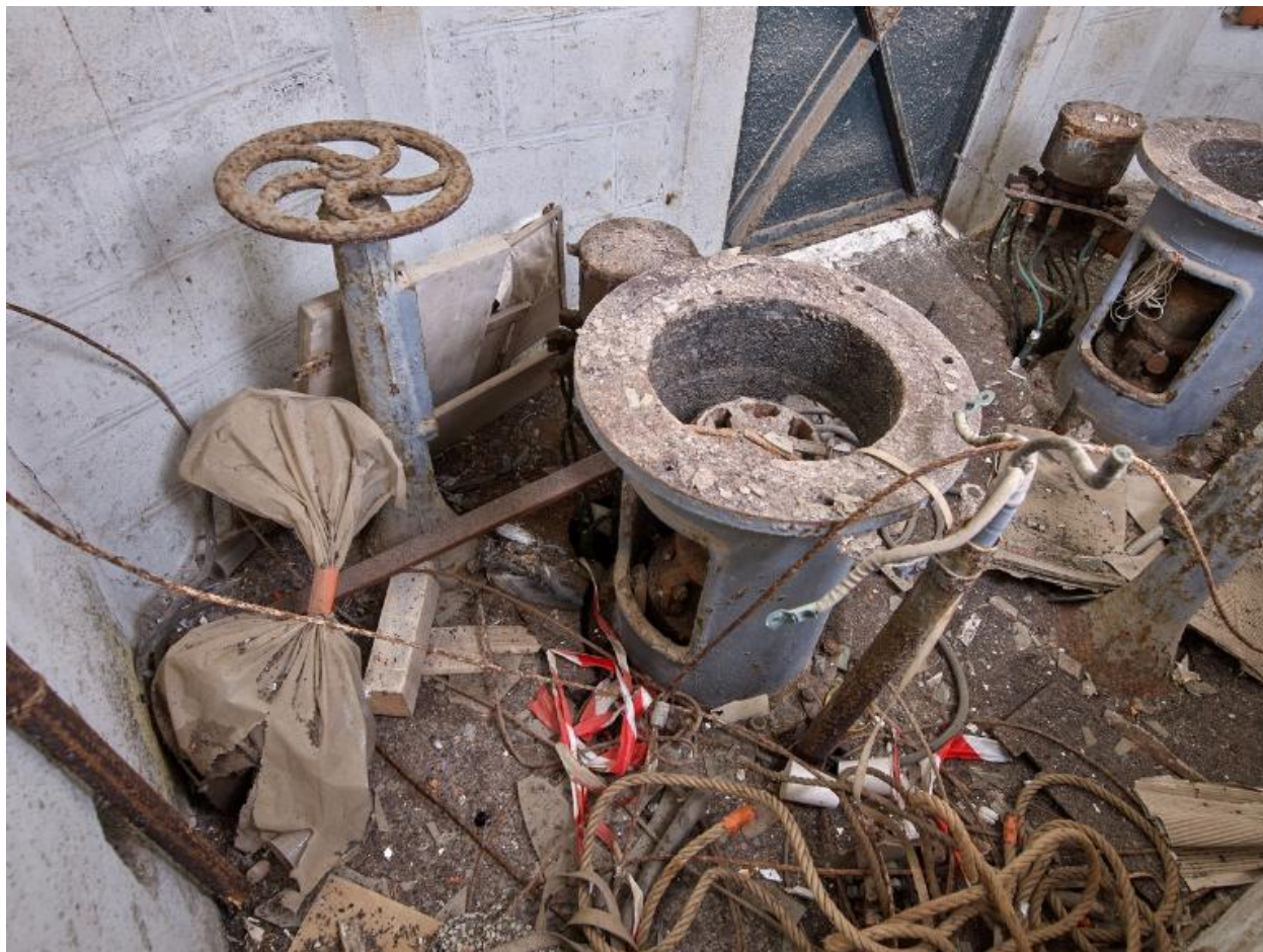
Vue de la salle des pompes située entre les alvéoles D (n° 19, 19a et 20) et E (n° 17 et 18) : les pompes ont été démontées
