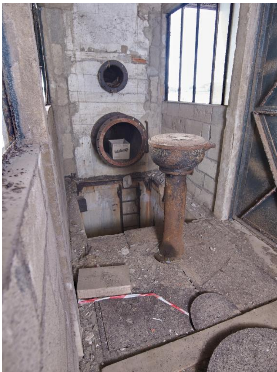
Vue de la salle des pompes de l'alvéole D (quai n° 19) : circuit d'eau de pompage intégré dans le mur de refend de l'alvéole
