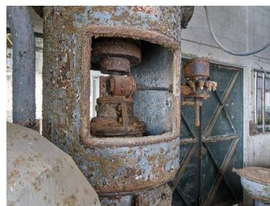
Vue de la salle des pompes située entre les alvéoles D (n° 19, 19a et 20) et E (n° 17 et 18) : détail du système Phot. Bernard Bègne IVR53_20235600088NUCA
