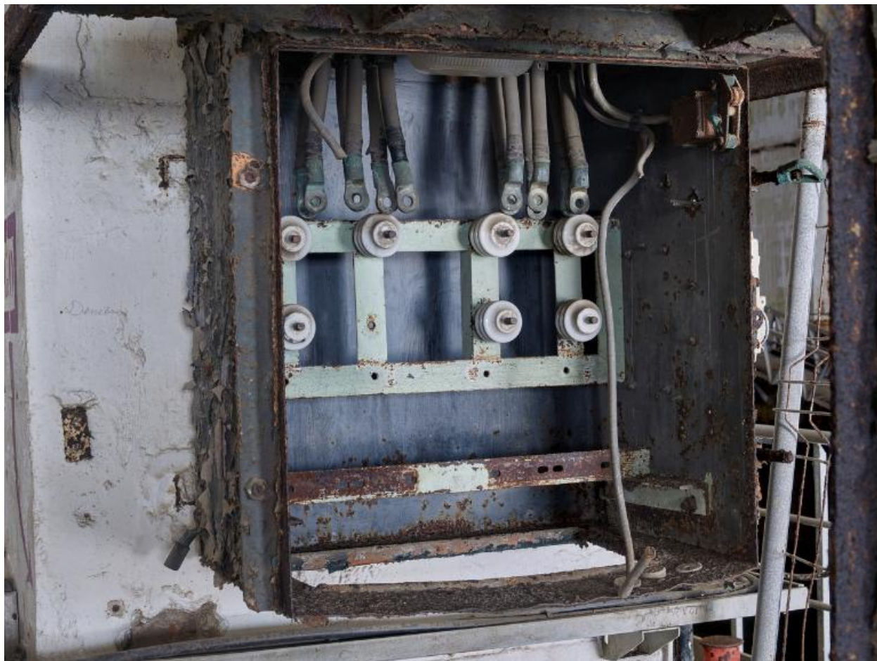
Vue du mur de refend situé entre les alvéoles C et D : tableau situé sous l'armoire électrique
