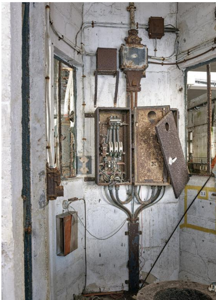
Vue de la salle des pompes située entre les alvéoles D (n° 19, 19a et 20) et E (n° 17 et 18) : sur les murs, faisceaux et tableaux électriques
