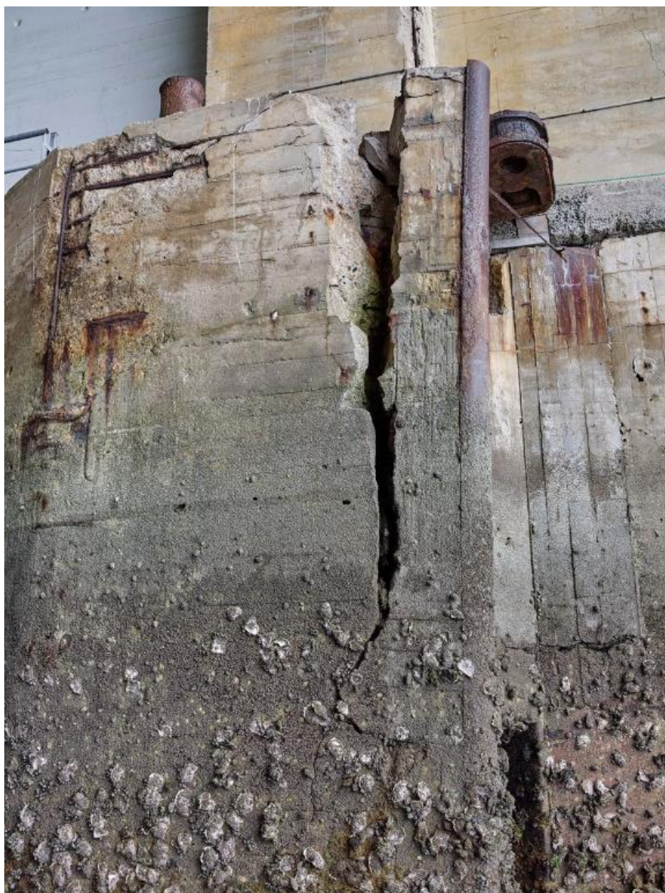
Vue de l'entrée de l'algéole D : entrée du quai n° 19 est montrant le vieillissement du béton armé
