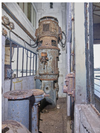
Vue de la salle des pompes située entre les alvéoles D (n ° 19, 19a et 20) et E (n° 17 et 18) Phot. Bernard Bègne IVR53_20235600087NUCA
