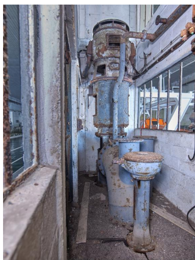
Vue de la salle des pompes située entre les alvéoles D (n ° 19, 19a et 20) et E (n° 17 et 18) Phot. Bernard Bègne IVR53_20235600083NUCA
