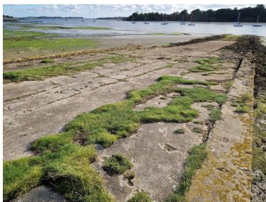
Vue générale vers la Penzé : dégradation et végétalisation spontanée de la partie supérieure en béton armé Phot. Guillaume Lécueillier IVR53_20242911152NUCA
