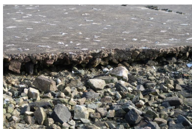
Vue de détail de la partie supérieure : dégradation du béton armé de la couche supérieure et de la maçonnerie par l'érosion marine Phot. Guillaume Lécueillier IVR53_20242911150NUCA
