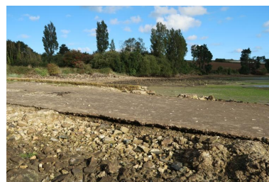
Vue de détail de la partie supérieure : dégradation du béton armé de la couche supérieure et de la maçonnerie par l'érosion marine Phot. Guillaume Lécueillier IVR53_20242911149NUCA
