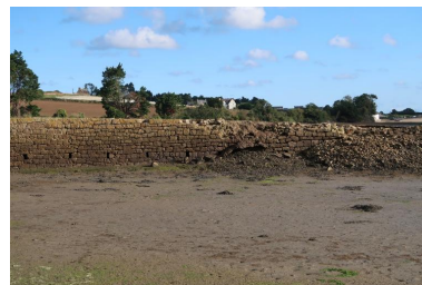
Vue de détail de l'élévation sud : maçonnerie de moellon de granite. Des portions de cale sont fortement dégradées par l'érosion marine Phot. Guillaume Lécueillier IVR53_20242911146NUCA
