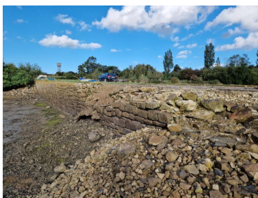
Vue de détail de l'élévation sud : dégradation de la maçonnerie de moellon de granite Phot. Guillaume Lécueillier IVR53_20242911148NUCA
