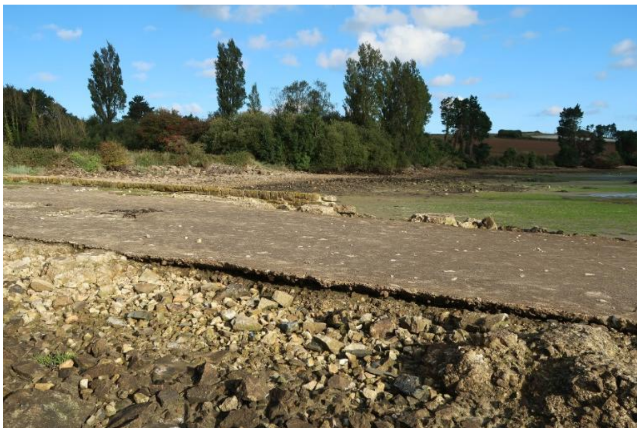
Vue de détail de la partie supérieure : dégradation du béton armé de la couche supérieure et de la maçonnerie par l'érosion marine
