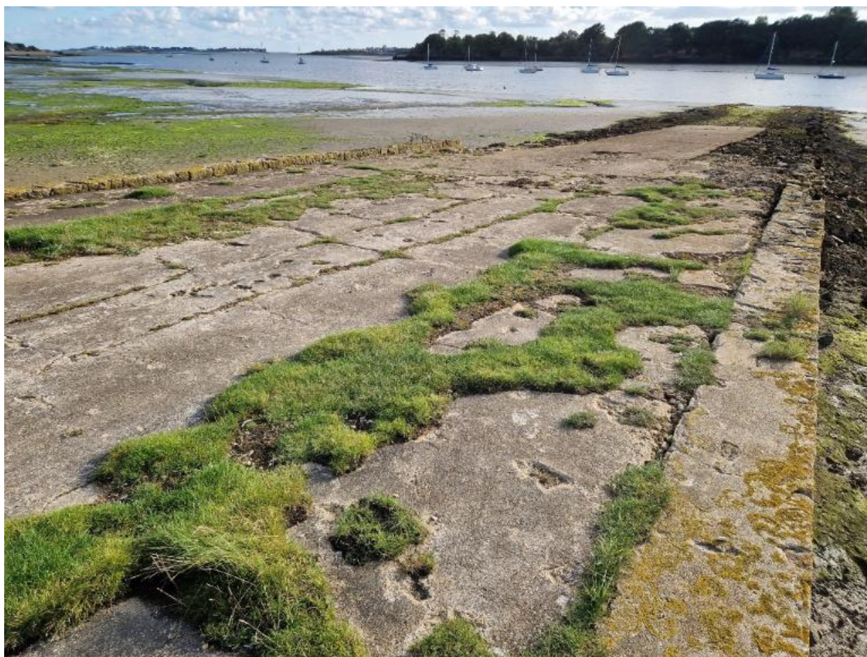
Vue générale vers la Penzé : dégradation et végétalisation spontanée de la partie supérieure en béton armé
