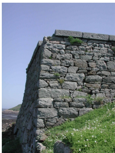
Vue de détail du mur de défense de la batterie nord-ouest de l'Île aux Moines : fissures provoquées par l'absence de barbicanes Phot. Guy Prigent IVR53_20062208840NUCA
