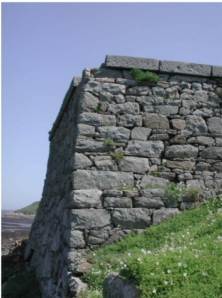
Vue de détail du mur de défense de la batterie nord-ouest de l'Île aux Moines : fissures provoquées par l'absence de barbicanes
