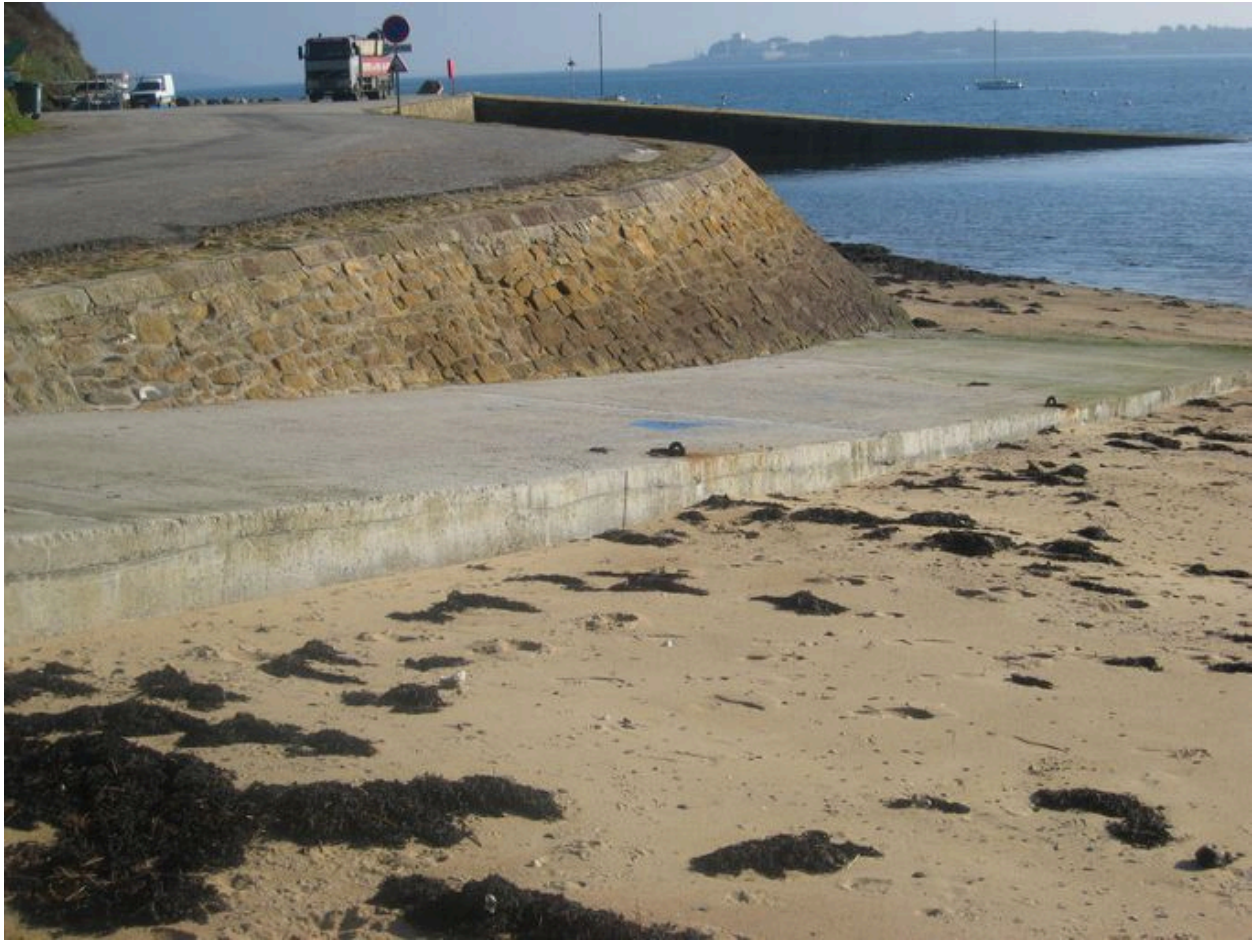
Débarcadère de Roscanvel avec cale récente au premier plan et cale de 1870 à l'arrière-plan
