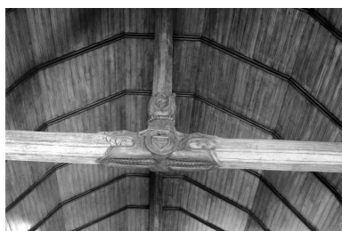
Intérieur, nef, charpente, retombée du poinçon : vue générale. Phot. François Dagorn IVR53_19723500512V
