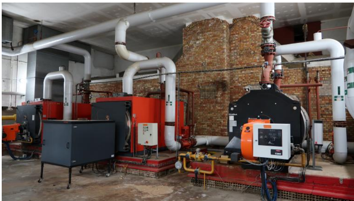
Chaufferie et souches de cheminées.
