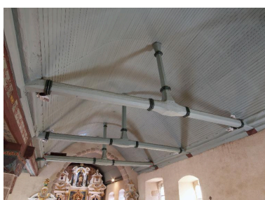
Intérieur : vue générale de la charpente de la nef Phot. Bernard Bègne IVR53_20133501969NUCA
