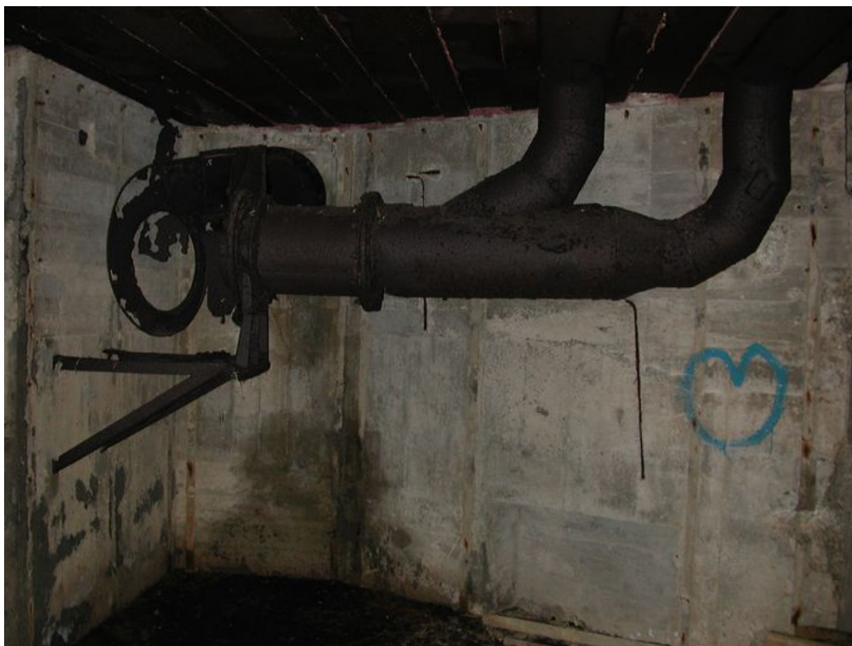
Vue du système de ventilation dans la chambre de tir (état en 2002). Il permettait l'extraction des fumées de tir
