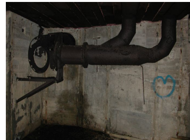
Vue du système de ventilation dans la chambre de tir (état en 2002). Il permettait l'extraction des fumées de tir Phot. Guillaume Lécueillier IVR53_20022901532NUCA
