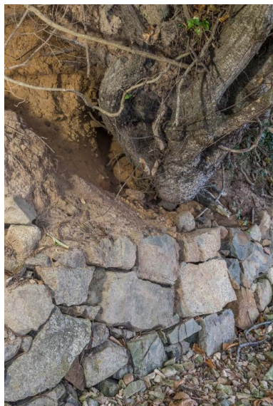
Mur de soutènement surmonté de terre limoneuse marquée par l'érosion marine et d'un arbre, au niveau de la baie de l'Enfer Phot. Charlotte Barraud IVR53_20242200701NUCA
