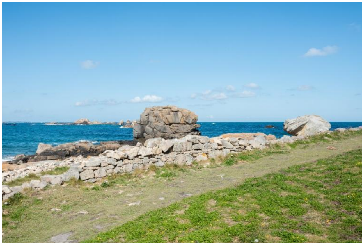
Muret en pierre sèche en partie effondré, bordant le sentier du site du Gouffre de Castel Meur
