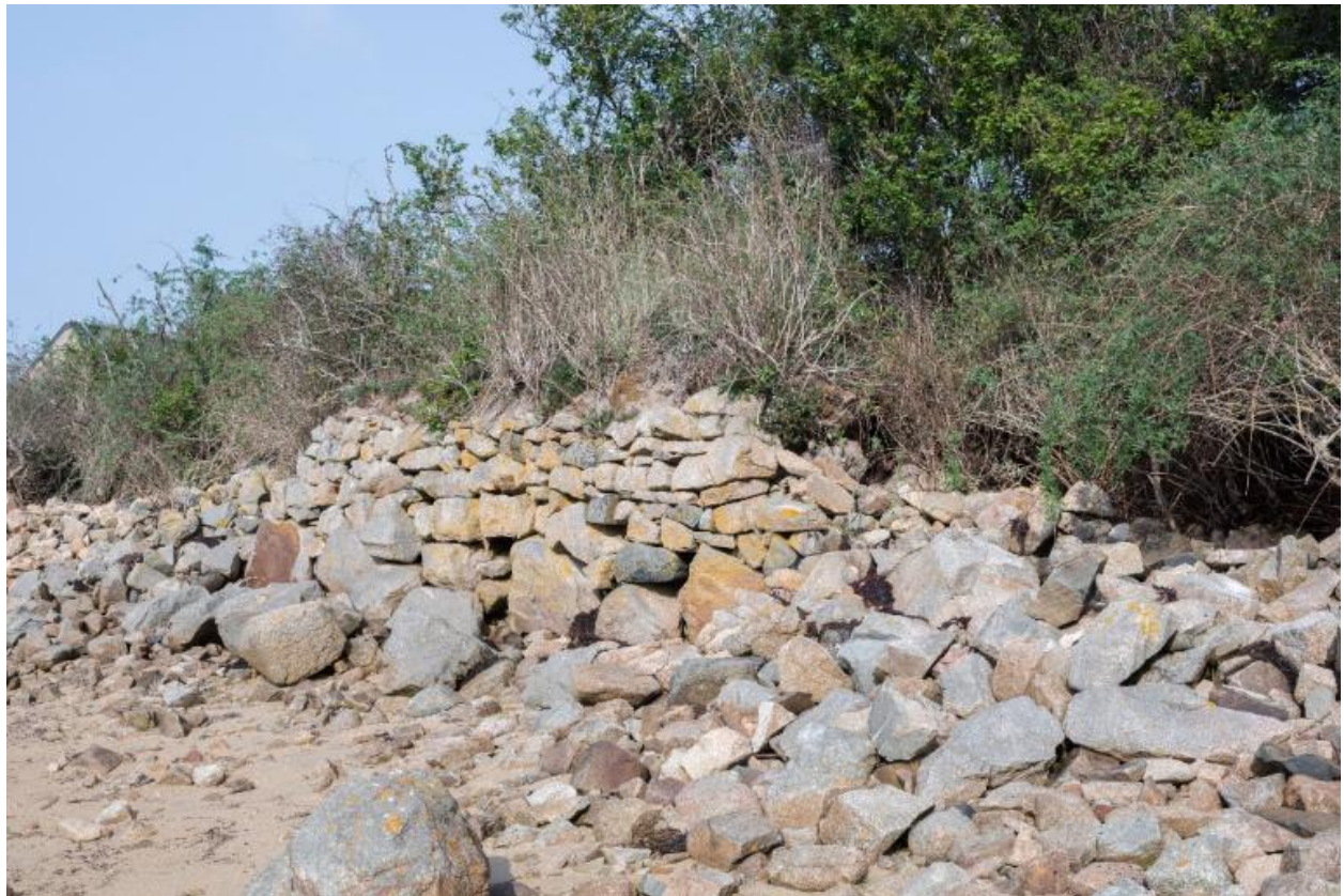
Mur de soutènement présentant des brèches, sur la rive est de l'anse de Pellinec
