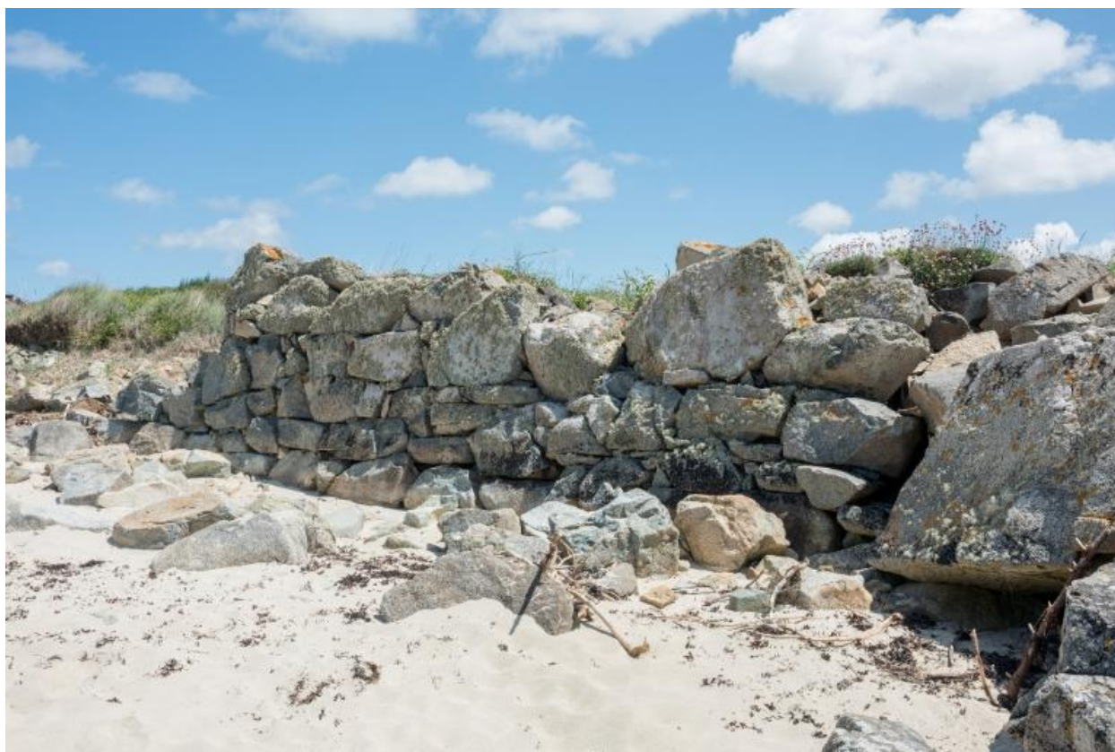
Vue d'ensemble d'un mur en pierre sèche de la plage de Crec'h Guezennec, recouvert par du lichen Ramalina siliquosa
