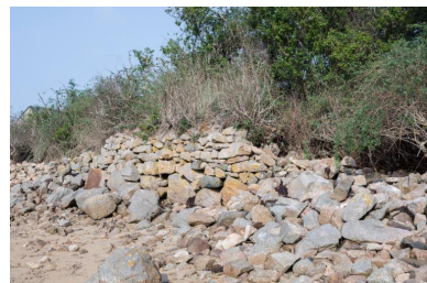
Mur de soutènement présentant des brèches, sur la rive est de l'anse de Pellinec Phot. Charlotte Barraud IVR53_20242200694NUCA
