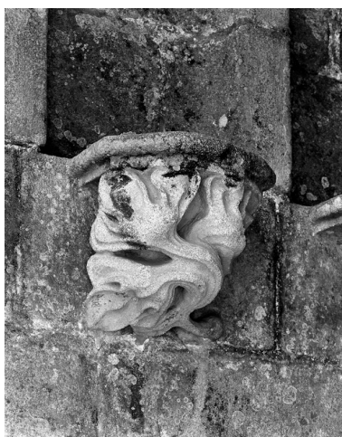
Porche sud, mur ouest, détail d'un culot sculpté. Phot. François Dagorn IVR53_19705600058X
